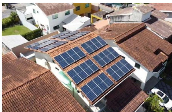
Figura 12 - Sistema Fotovoltaico Instalado com Módulos Orientados Para Diferentes Orientações.
