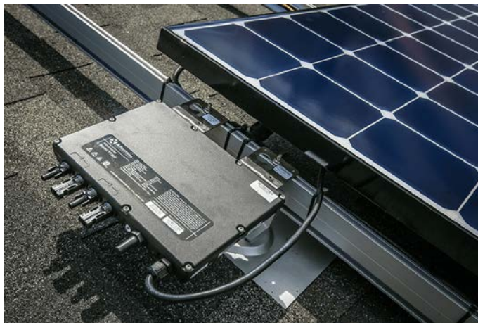
Figura 13 - Microinversor Apsystems Instalado.
