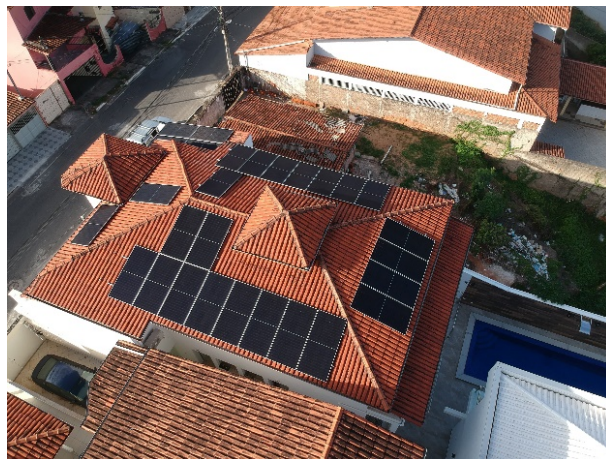
Figura 8 - Instalação de um Sistema com Microinversores e Quatro Orientações Diferentes do Telhado
