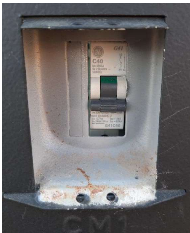
Figura 11 - Disjuntor do quadro de medição
