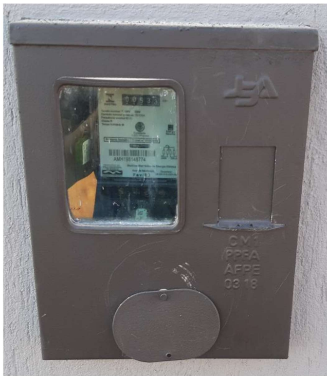
Figura 10 - Quadro de medição instalado na residência
