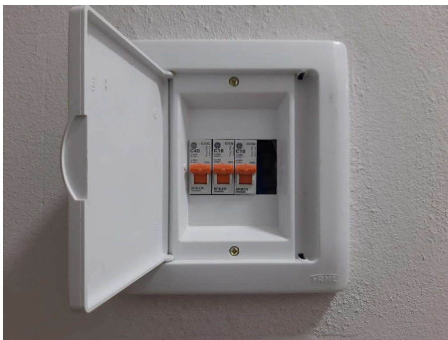
Figura 12 - Quadro de distribuição
