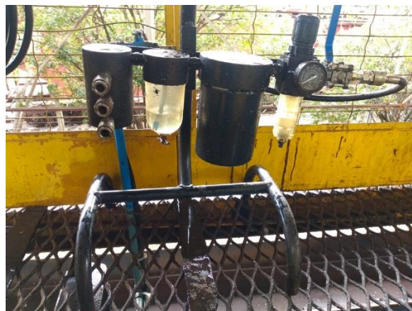
Figura 7 - Sistema de arco filtro
