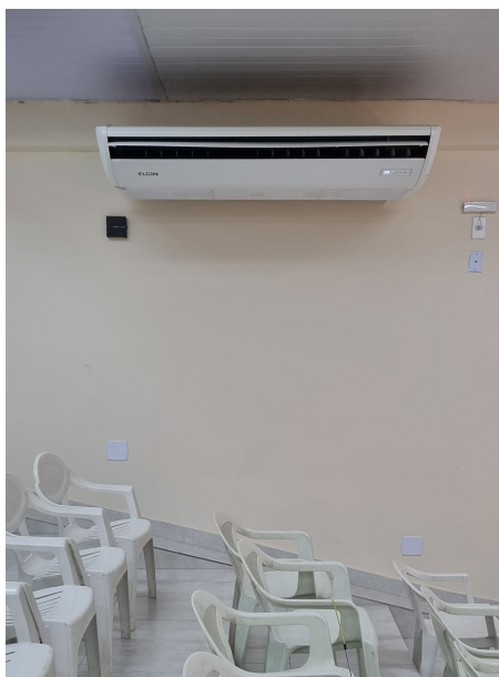
Figura 3.4 – Evaporadora do condicionador de ar split piso-teto do segundo andar.
