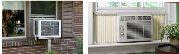
Figura 2.4 – Condicionador de ar do tipo janela visto no interior e exterior de um quarto.
