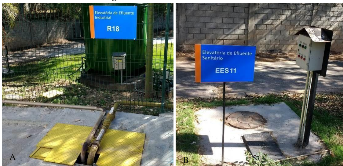
Figura 15 – Elevatórias de efluentes
