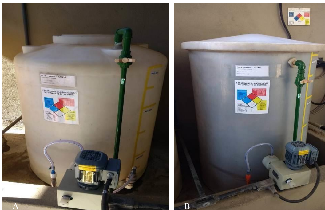
Figura 40 – Reservatórios de produtos químicos
