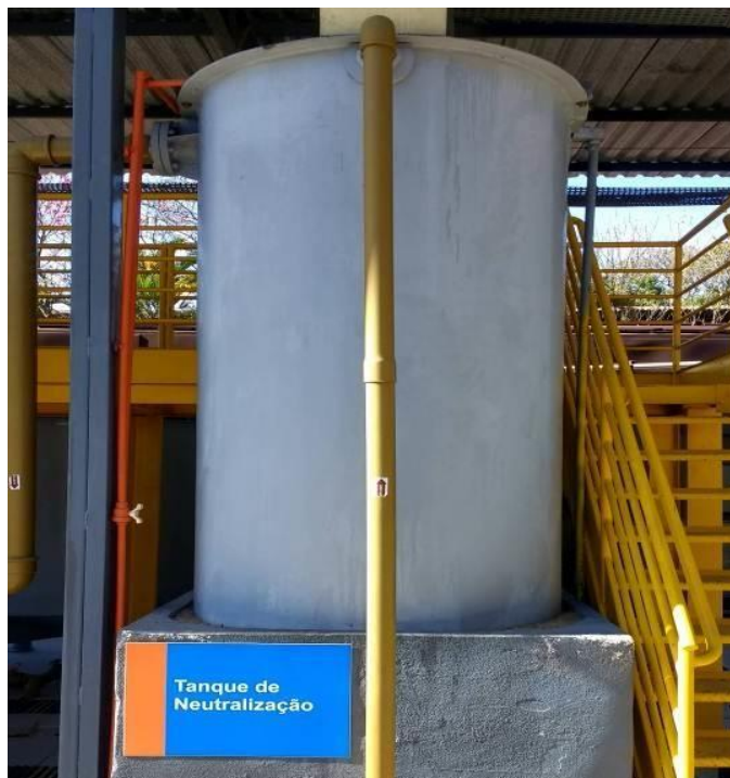
Figura 23 – Tanque de neutralização
