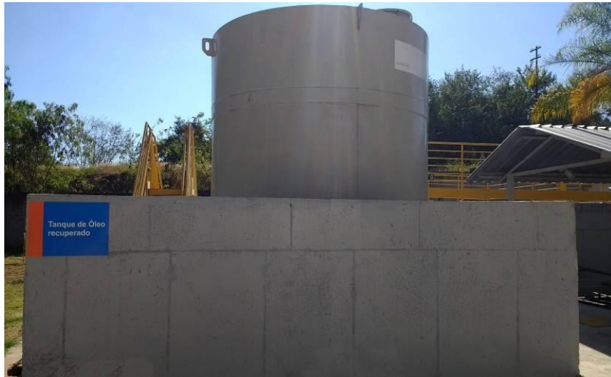
Figura 2010 – Caixa de transferência de óleo da SAO
