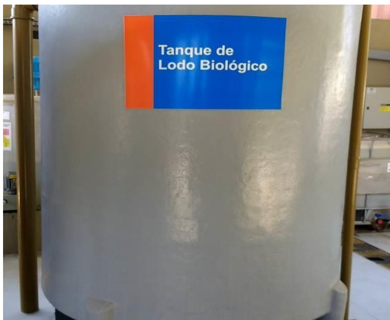
Figura 36 – Tanque de lodo biológico
