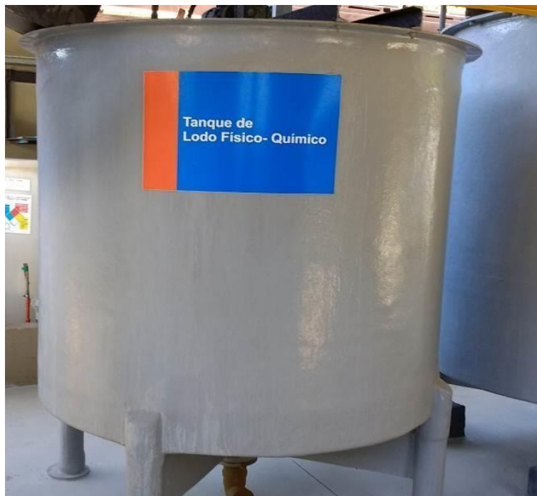
Figura 29 – Tanque de lodo físico-químico
