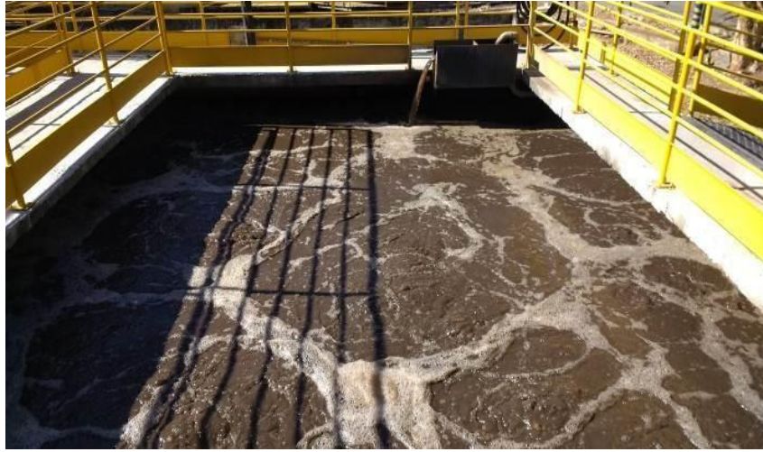
Figura 33 – Tanque de aeração (lodo biológico)
