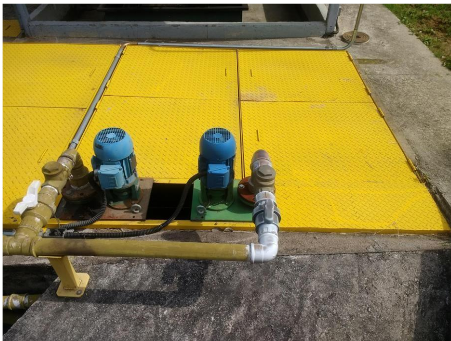
Figura 111 – Caixa de transferência do efluente bruto
