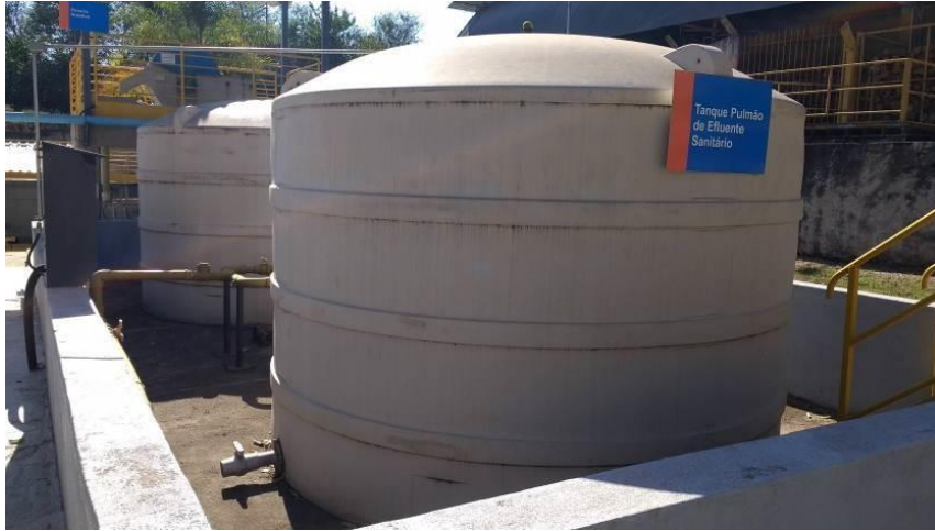
Figura 32 – Tanque pulmão sanitário
