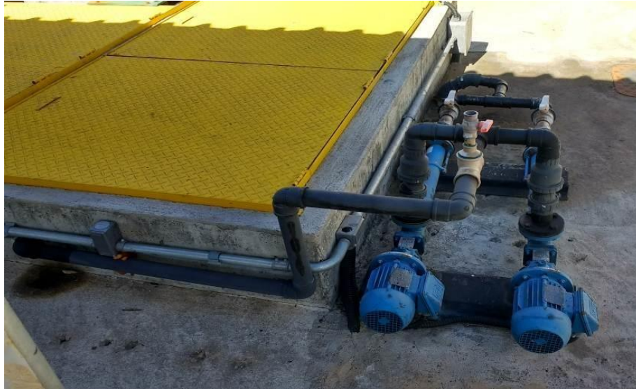
Figura 99 – Caixa de transferência de óleo da SAO
