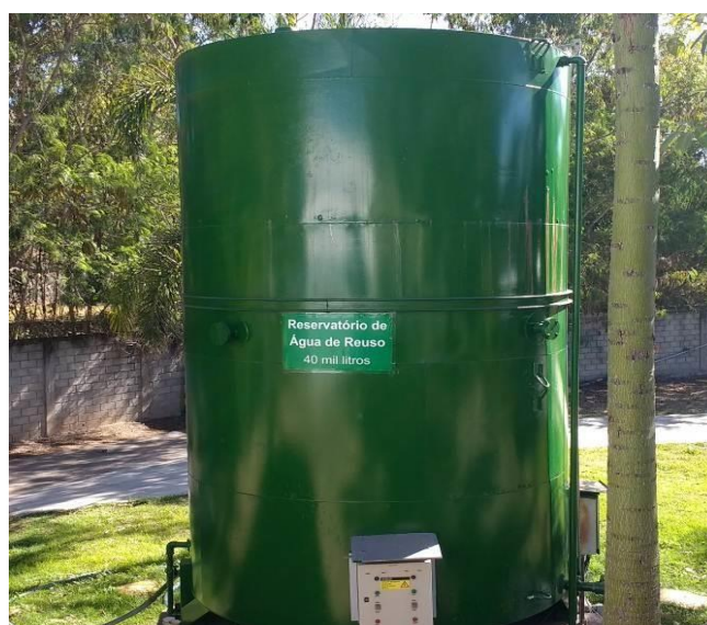
Figura 39 – Reservatório de água de reúso
