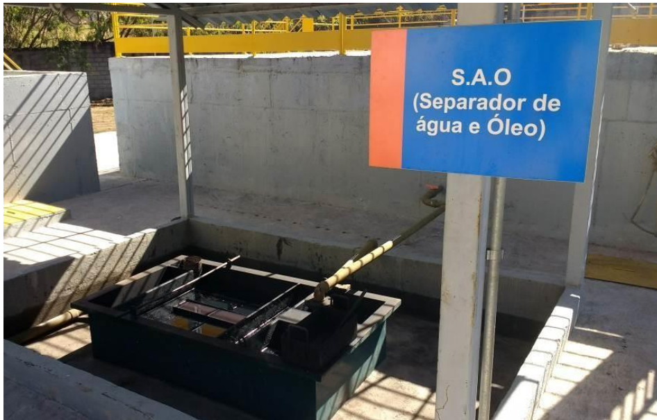
Figura 88 – Separador água e óleo (SAO)
