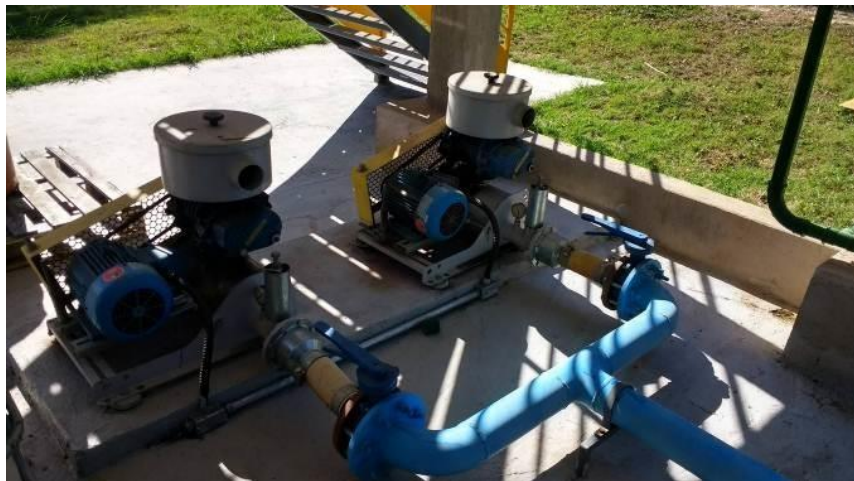
Figura 34 – Sopradores de ar
