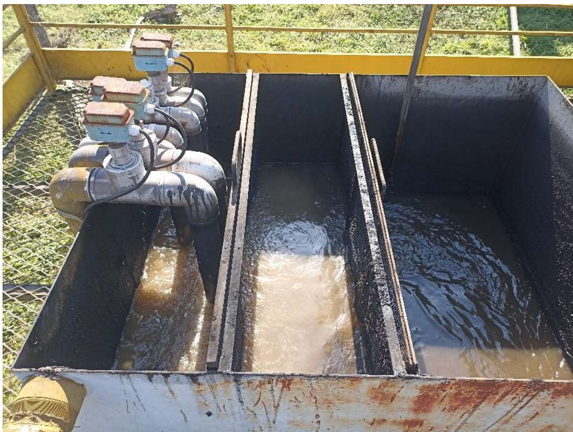
Figura 24 - Coleta do efluente bombeado das elevatórias para o gradeamento – VLI Divinópolis – MG
