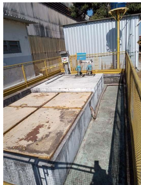
Figura 22 - Elevatória secundar R1
