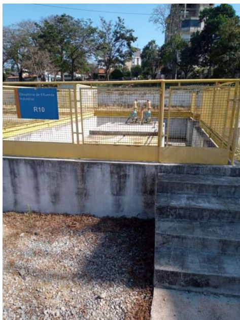
Figura 21 - Elevatória preliminar R10
