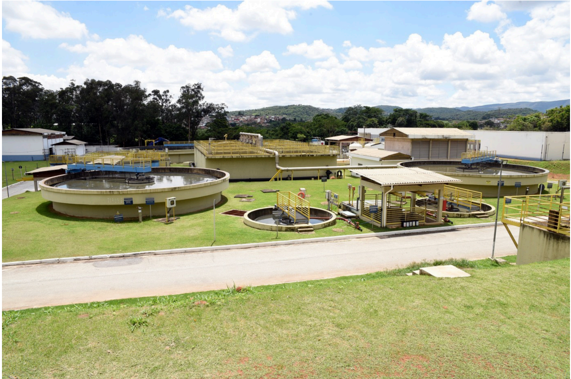
Figura 11 - Estação de Tratamento de Esgoto (ETE) analisada
