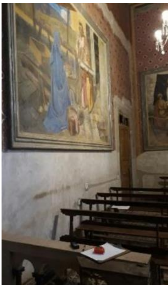
Figura 8: Perda de argamassa original.
