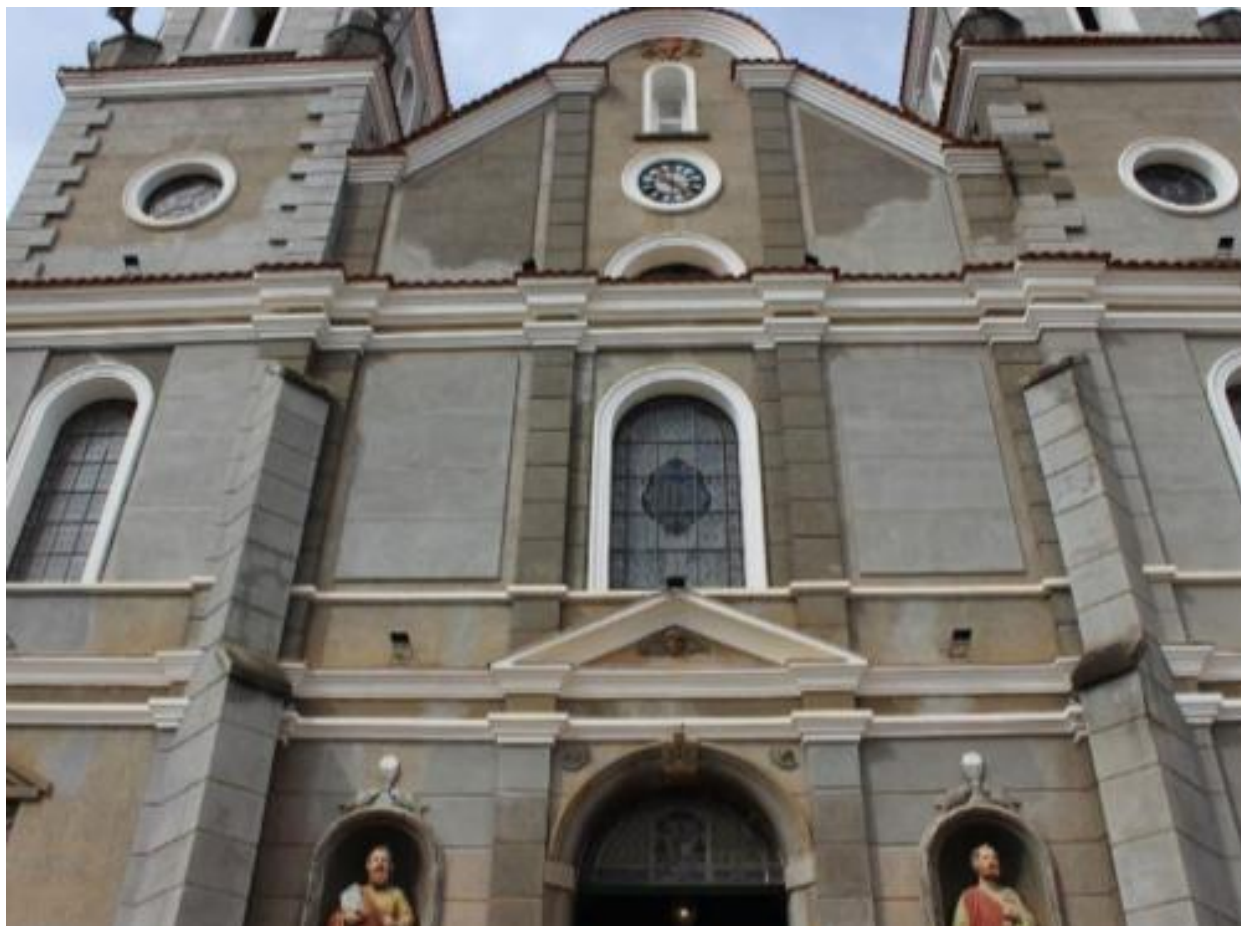
Figura 37: Vista frontal da Matriz, evidenciando as sujidades e diferença de tonalidade da argamassa irregular.
