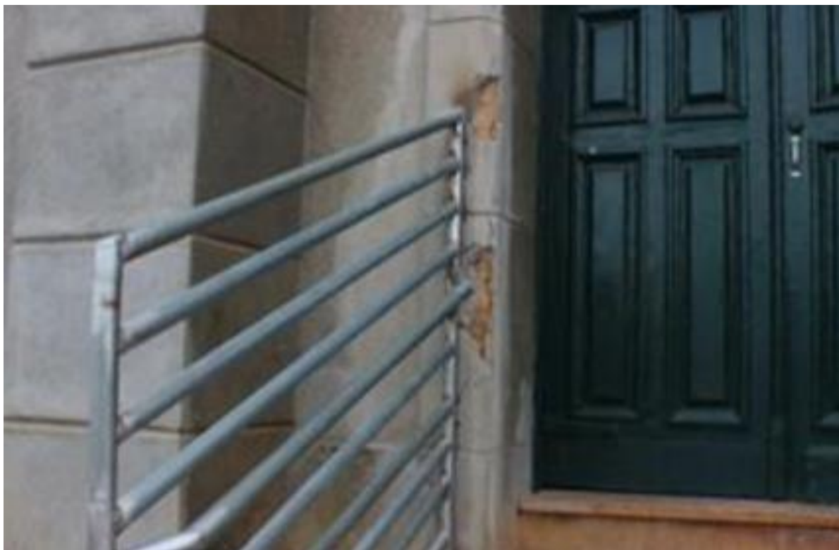
Figura 38:Corrimãos causando danos no revestimento.
