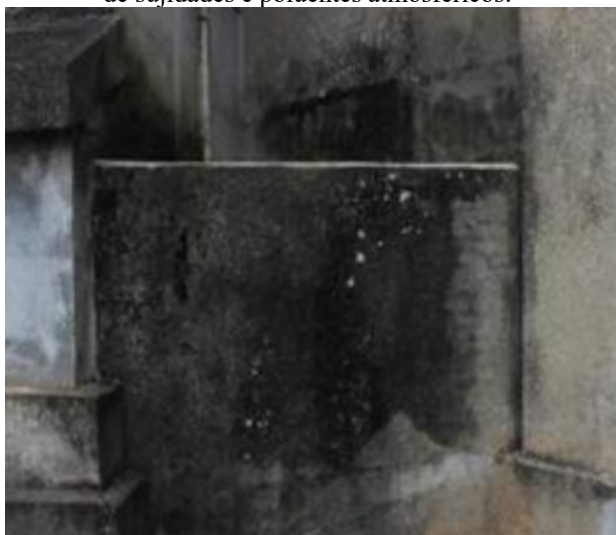
Figura 35: Manchas escurecidas associadas ao acúmulo de sujidades e poluentes atmosféricos.
