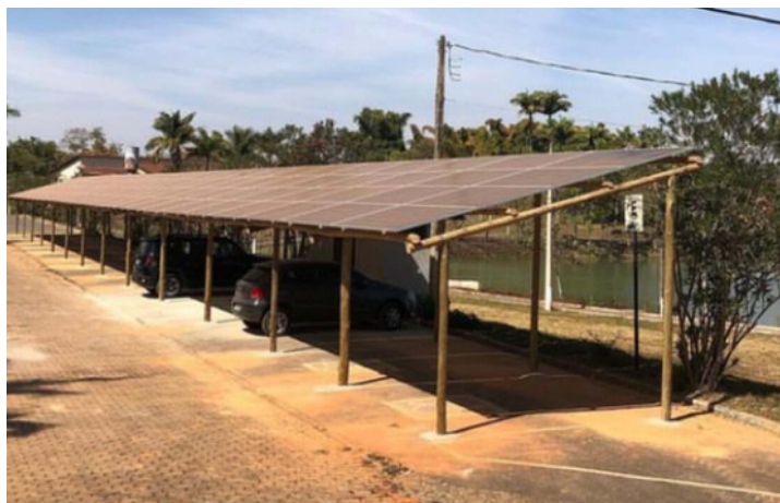
Usina Solar em estacionamento localizada no IFMG - Campus Bambuí.
