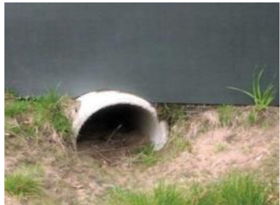
Figura 19. Bueiro utilizado para deslocamento de anfíbios e reptéis. Fonte: Google Imagens (2021).
