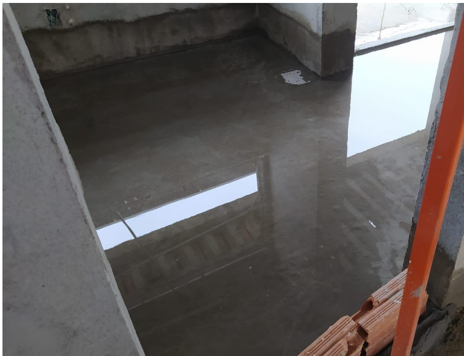
Figura 19 - Teste de estanqueidade.
