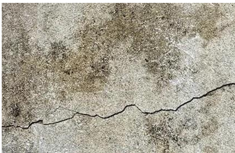
Figura 8 – Trincas e fissuras.
