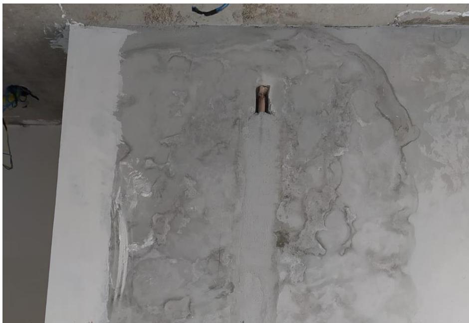
Figura 20 - Mancha causado por vazamento de água.
