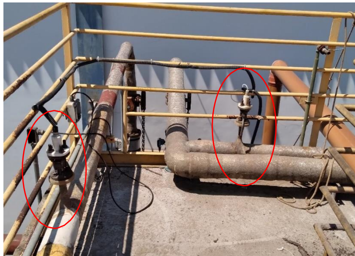
Foto 4: Mangueras na bomba e na bombona
