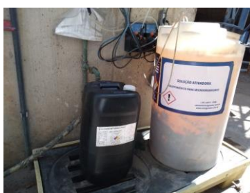
Foto2: palete de contenção com as bombonas
