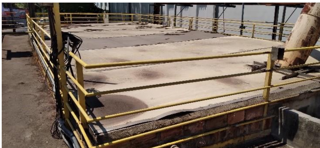
Figura 13 – Tanque de Equalização
