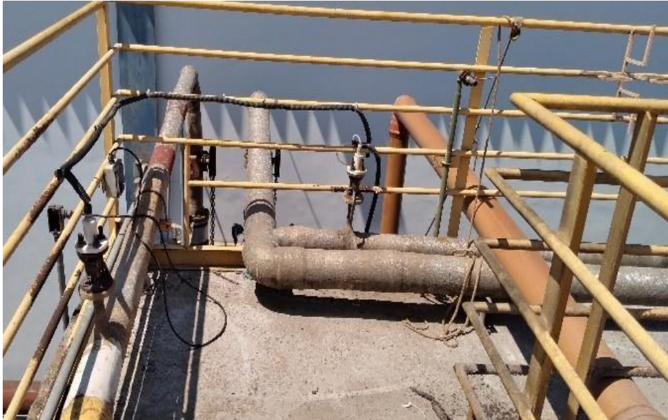
Figura 22 – Ponto de dosagem do MC no tanque de lodos ativados
