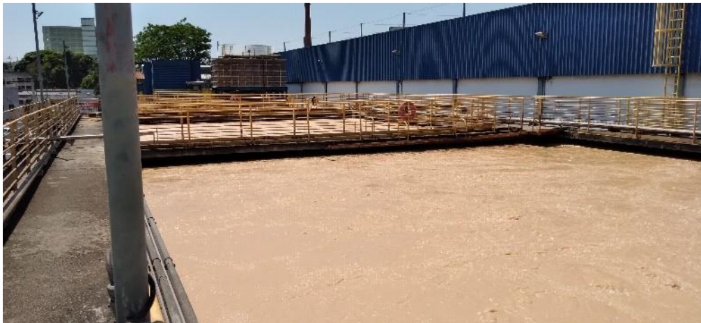
Figura 15 – Tanque de Lodos Ativados
