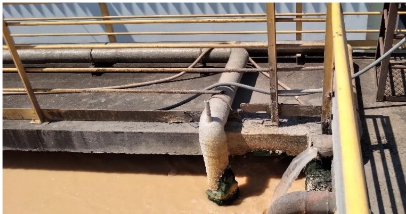
Figura 23 – Ponto de entrada do efluente + MC no tanque de lodos ativados
