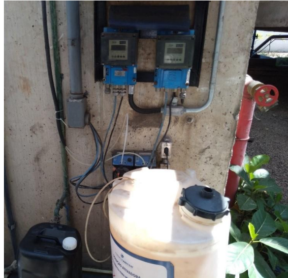
Foto3: Mangueras na bomba e na bombona
