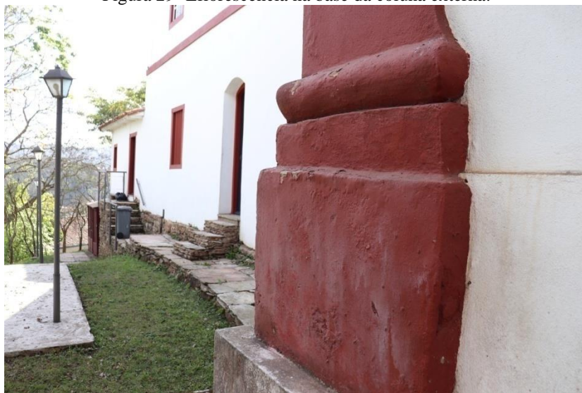
Figura 29- Eflorescência na base da coluna externa.
