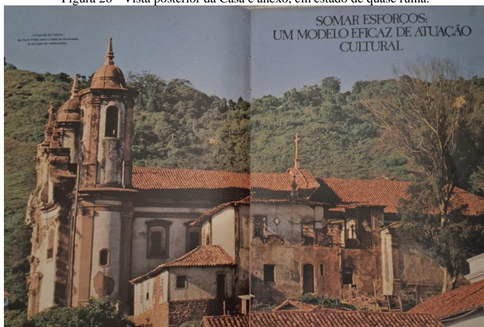
Figura 26 - Vista posterior da Casa e anexo, em estado de quase ruína.
