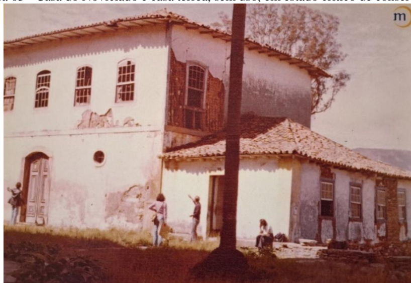
Figura 03 - Casa do Noviciado e casa térrea, sem uso, em estado crítico de conservação.
