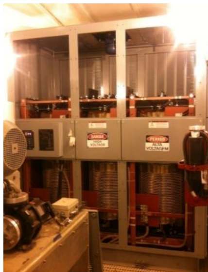
Figura 4 – DPT (Transformador de Potência Principal).
