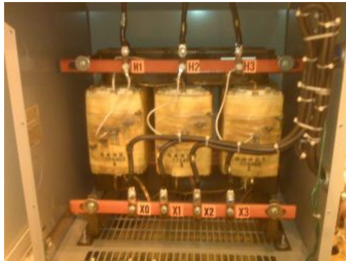
Figura 5 – Transformador de abertura de caçamba DTT: Visão interna
