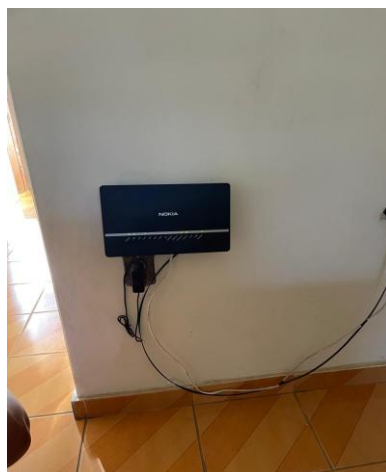
Figura 12 – Localização atual do roteador na sala de atendimento
