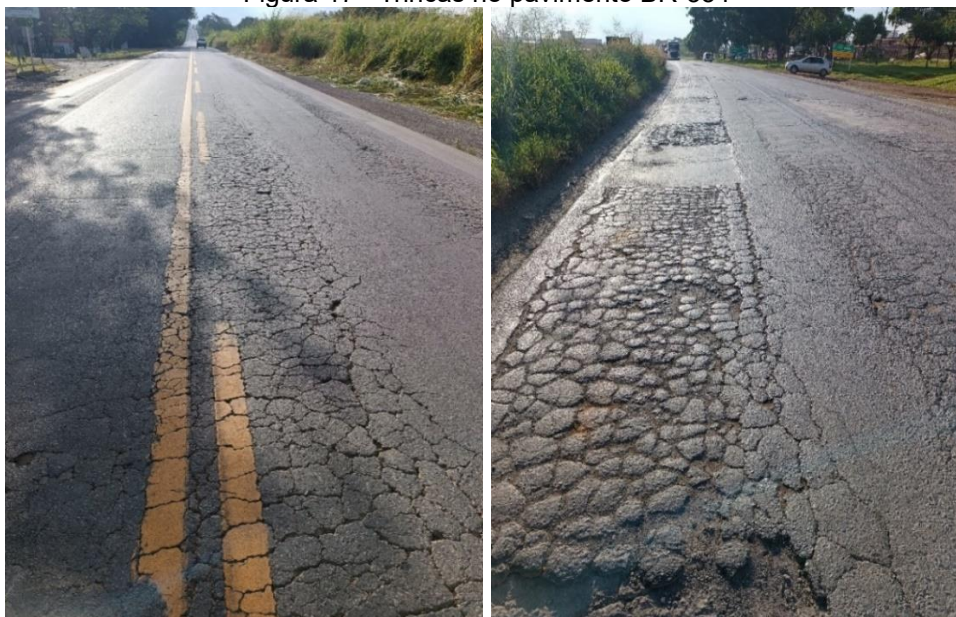
Figura 17 - Trincas no pavimento BR-354
