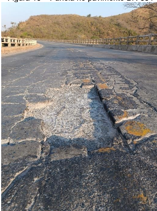
Figura 16 – Panela no pavimento BR-354
