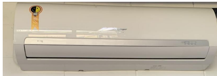
Figura 12 - Unidade evaporadora – área de Show Room
