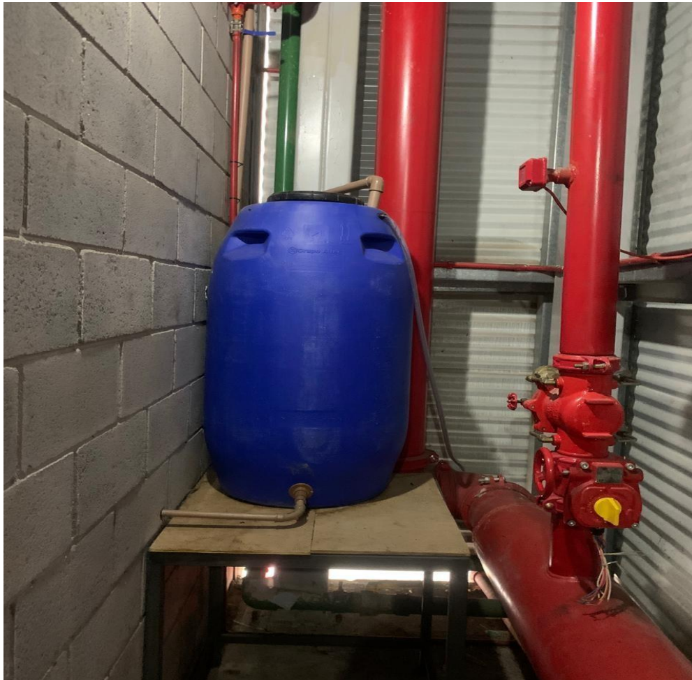
Figura 17 - Reservatório da água de condensação instalado na casa de máquinas (térreo)
