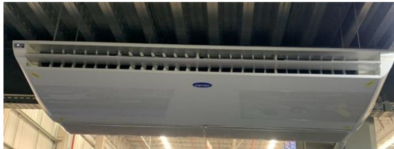
Figura 11 - Unidade evaporadora - área de televisão
