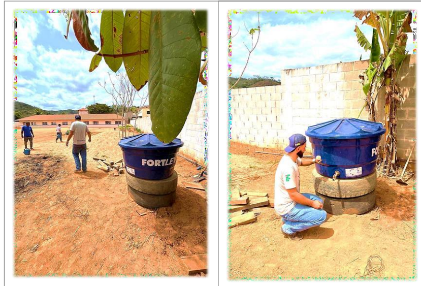
Figura 28 - Instalação de uma caixa d'água com os alunos do Ensino Fundamental de uma escola pública em São João Evangelista (MG).
