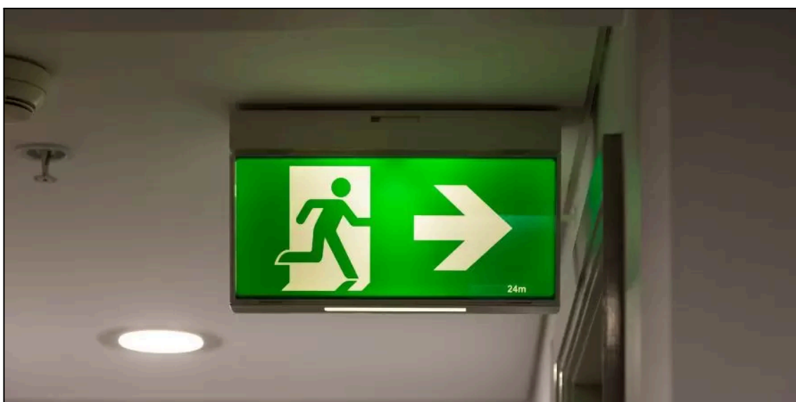
Figura 09 - Luminária de emergência em rota de fuga
