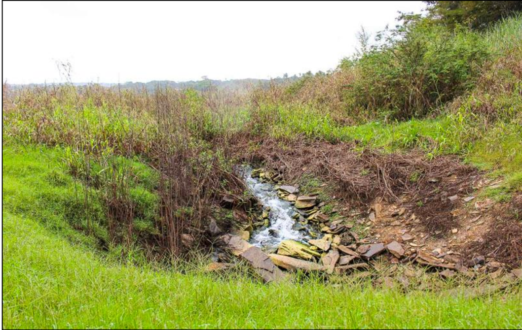
Figura 11 - Sumidouro no Córrego Samambaia
