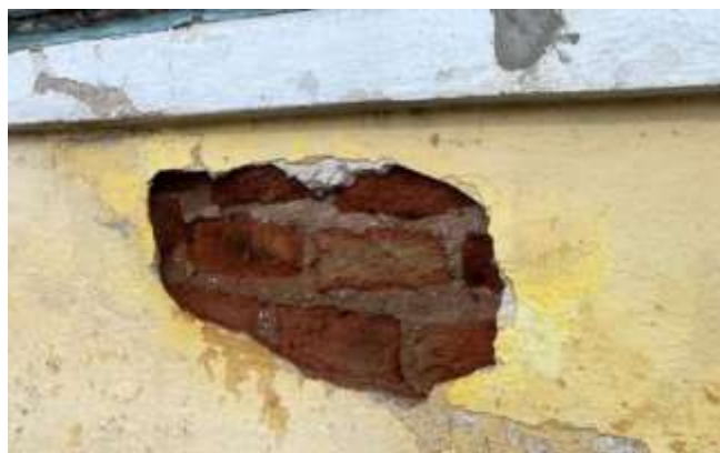
Figura 3 – Descolamento de Revestimento
