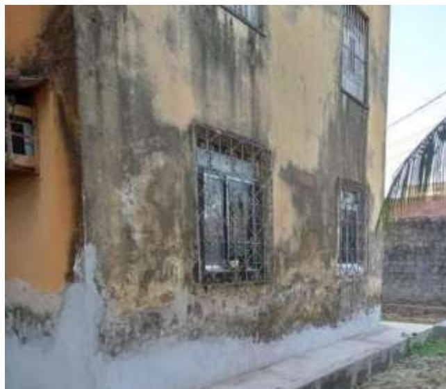
Figura 4 – Fachada com Presença de Mofo
