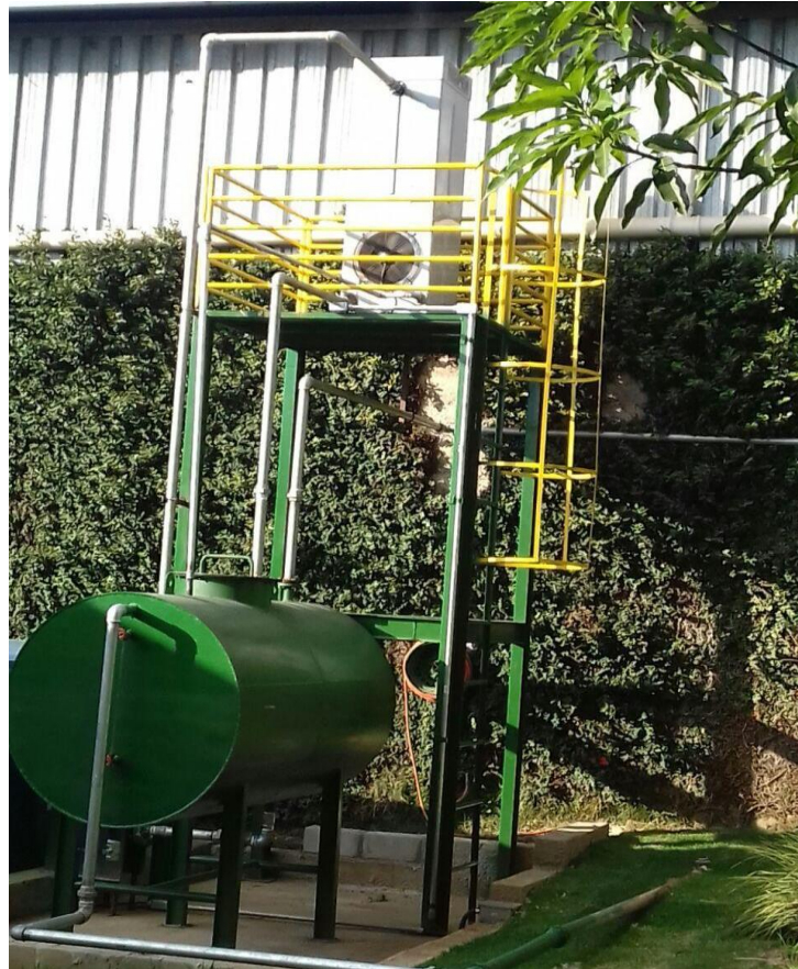
FIGURA 18 - TORRE DE RESFRIAMENTO E RESERVATÓRIO DE ÁGUA
