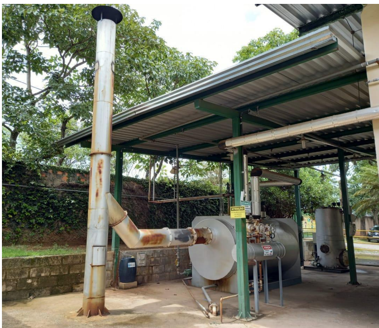
FIGURA 16 - CALDEIRA DE PRODUÇÃO DE VAPOR DA EMPRESA VIASOLO ENGENHARIA AMBIENTAL S/A
