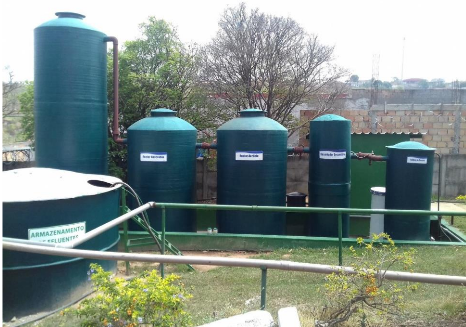
FIGURA 20 - ESTAÇÃO DE TRATAMENTO DE EFLUENTE (ETE)
