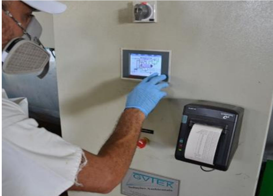
FIGURA 17 - PAINEL DA AUTOCLAVE PARA ACOMPANHAMENTO DO CICLO DE TRATAMENTO
