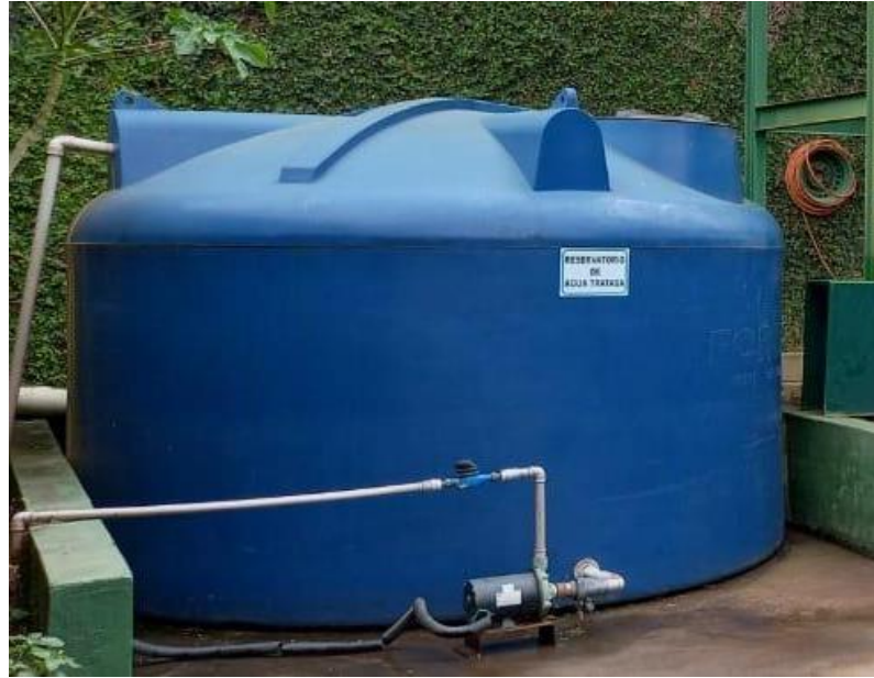
FIGURA 26 - RESERVATÓRIO DE ÁGUA RESIDUÁRIA TRATADA (RART)
