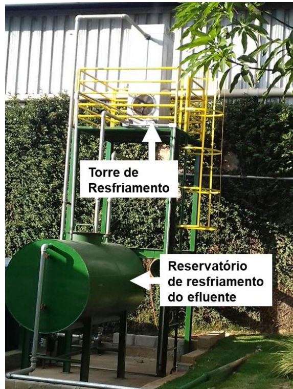
FIGURA 23 - TORRE DE RESFRIAMENTO E RESERVATÓRIO DE EFLUENTE
