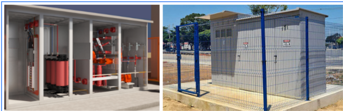
Figura 14 – Cabine primária blindada
