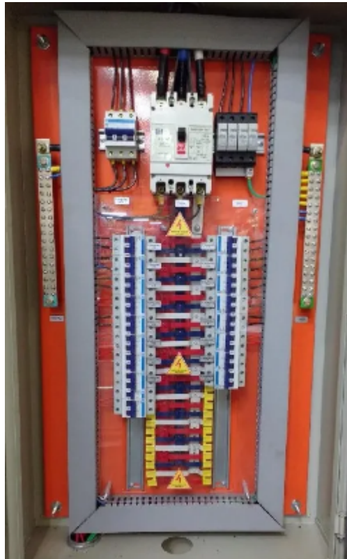
Figura 16 – QGBT -Quadro Geral de Baixa Tensão
