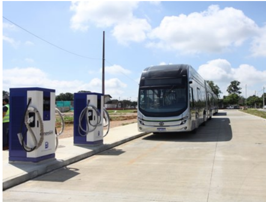
Figura 31 – Estações de recarga de 200 kW com duas saídas CCS2
