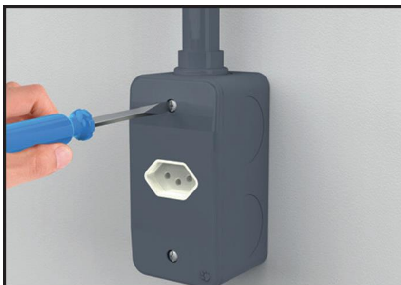
Figura 18 - Ponto de tomada em condutele de PVC.
