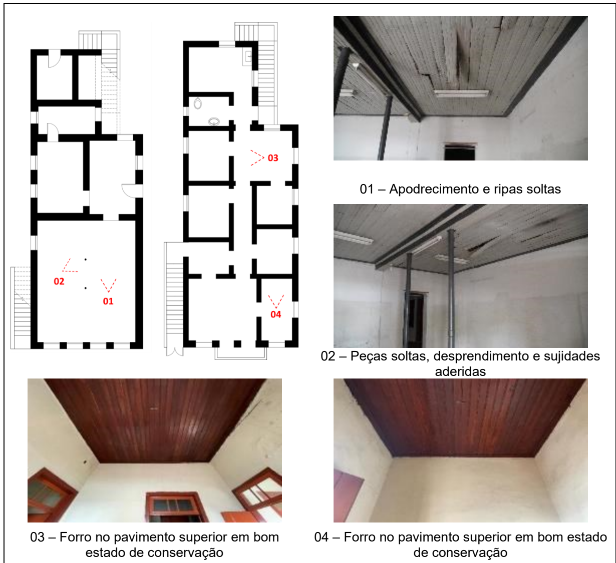
Figura 40: Danos relacionados aos forros e/ou à cobertura.
