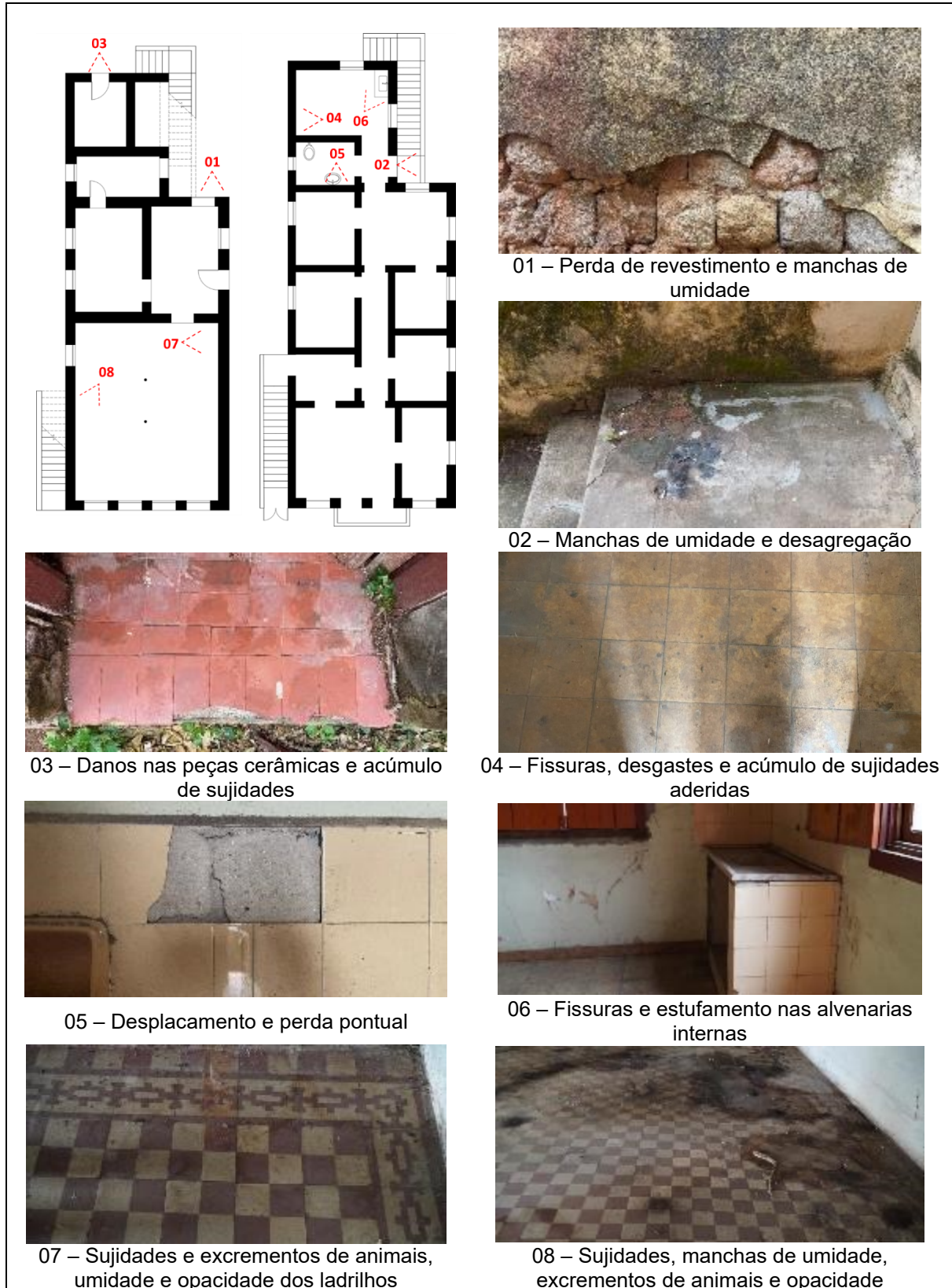
Figura 38: Danos relacionados aos pisos e revestimentos.
