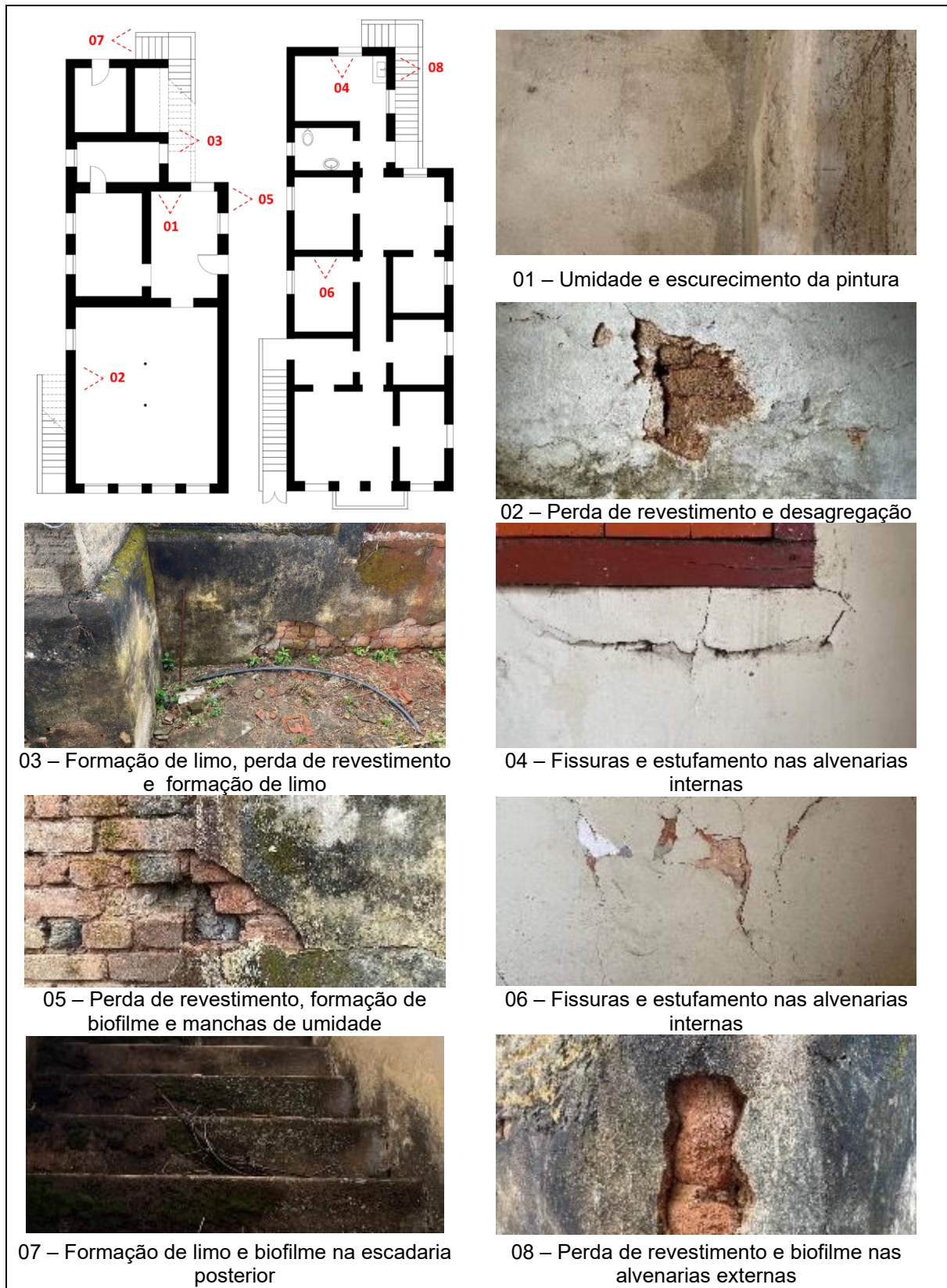
Figura 37: Danos relacionados ao sistema estrutural e/ou às alvenarias.
