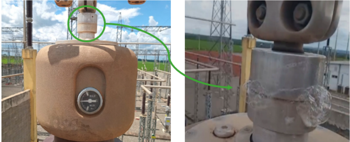
Figura 19 – Vazamento no terminal da bucha de H1.
