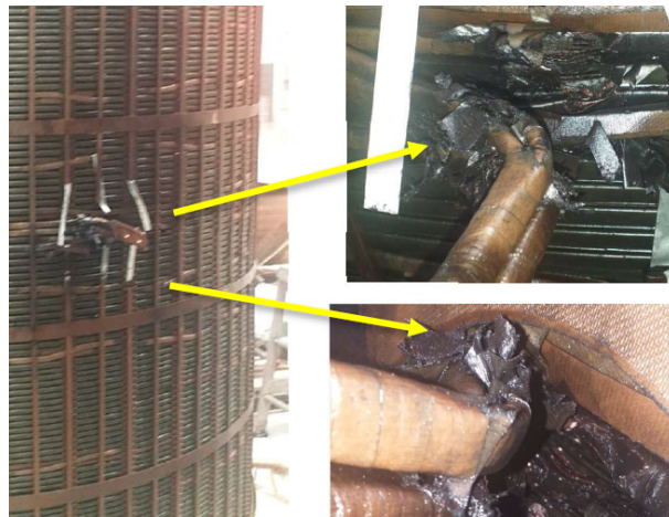
Figura 24 – Fusão de material condutor, no ponto de falha.
