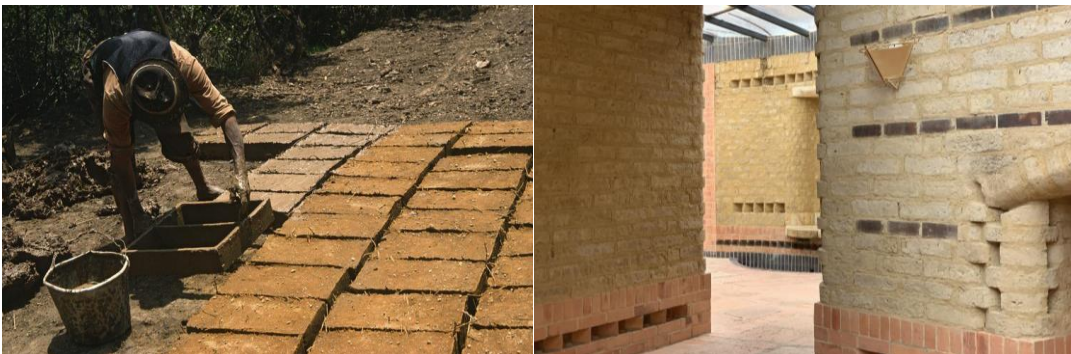
Figura 23 e 24 - Confeção dos tijolos de Adobe e resultado final aplicado em paredes.
