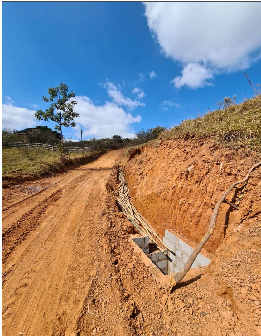
Figura 34: Exemplo de dissipador instalado na Estrada do Ambrósio, no trecho do Morro do Chapéu.
