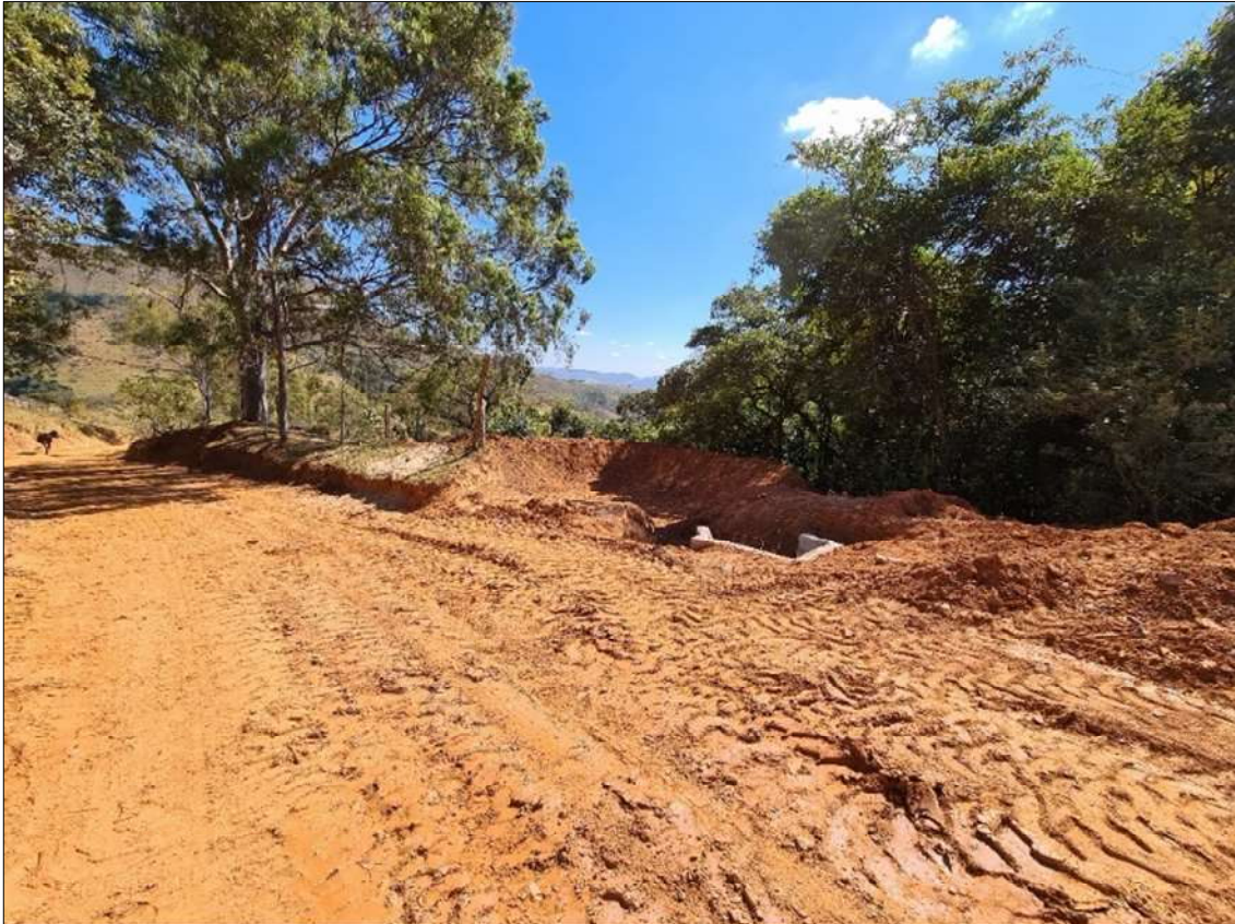
Figura 49: Imagem antes, no momento da intervenção no trecho Morro do Chapéu do Ambrósio.
