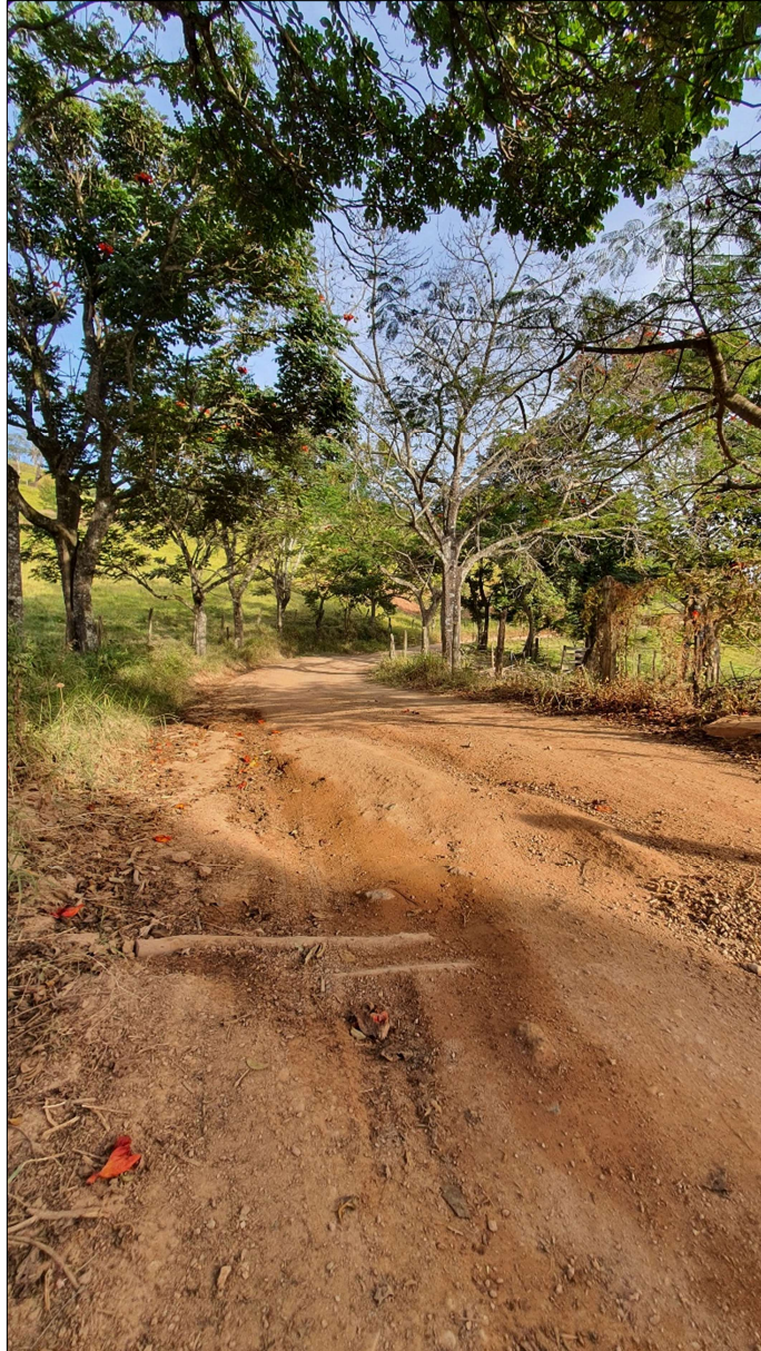
Figura 13: Trecho de estrada com sulcos, localizado em Capitólio - MG.
