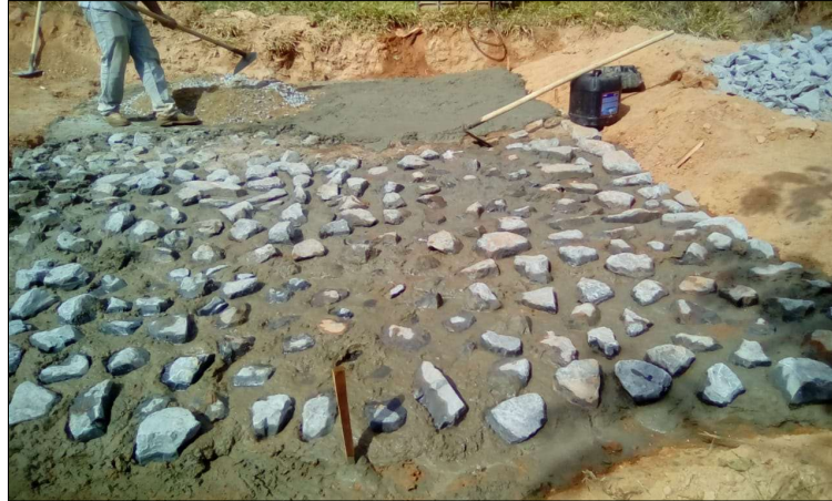
Figura 31: Exemplo de sangra com auxílio de passagem molhada na estrada do Ambrósio.
