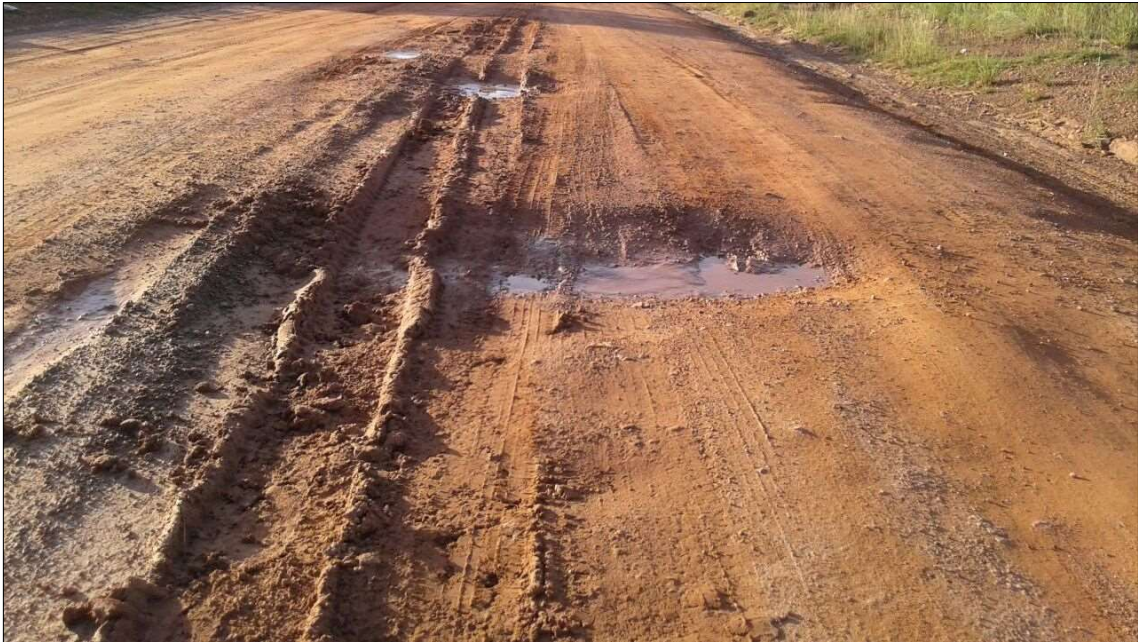
Figura 17: Trecho de estrada com buraco e afundamento de trilha de roda.
