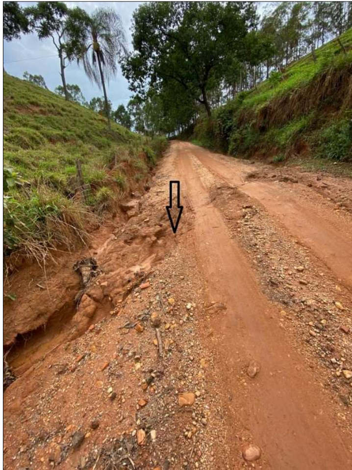
Figura 16: Trecho de estrada com erosão, localizado na comunidade do Ambrósio em Capitólio - MG.
