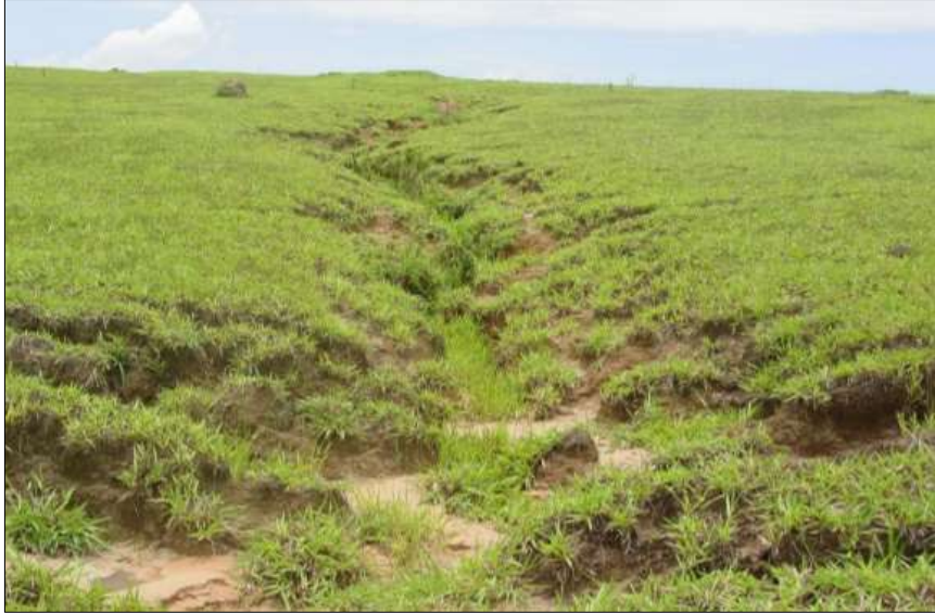
Figura 14: Trecho de terreno com erosão do tipo ravina, localizado em São Pedro - SP.
