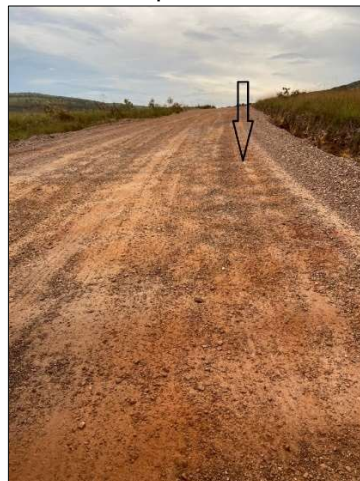
Figura 11: Trecho de estrada com ondulações, localizado na estrada para a Cachoeira da Capivara em Capitólio - MG.
