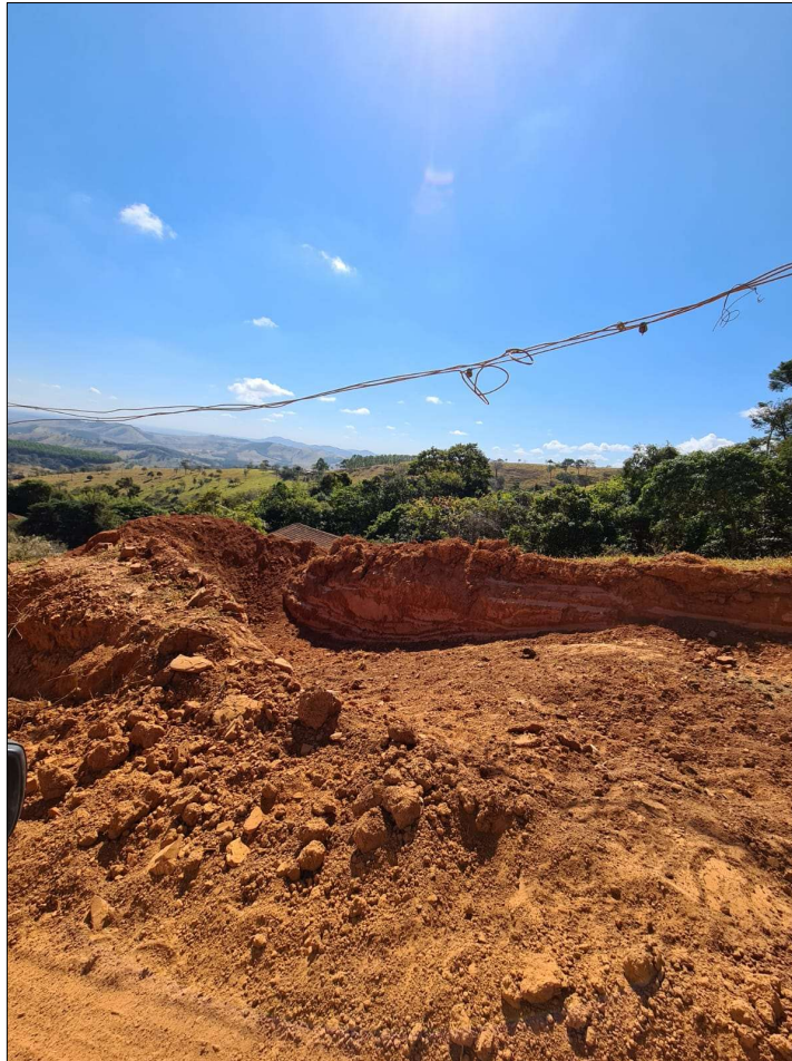
Figura 26: Caixa de captação localizada na estrada do Ambrósio em Capitólio - MG.
