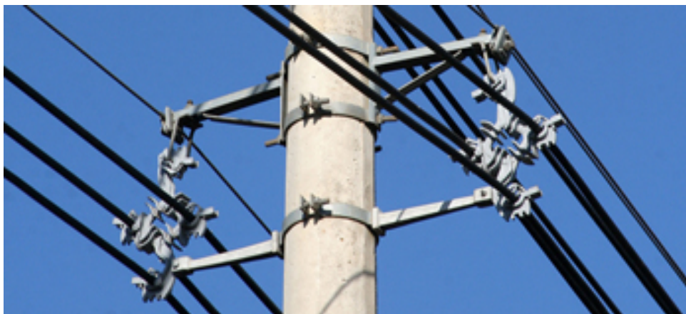
Figura 4 – Rede de distribuição aérea compacta (ATSELETRICA, 2023).
