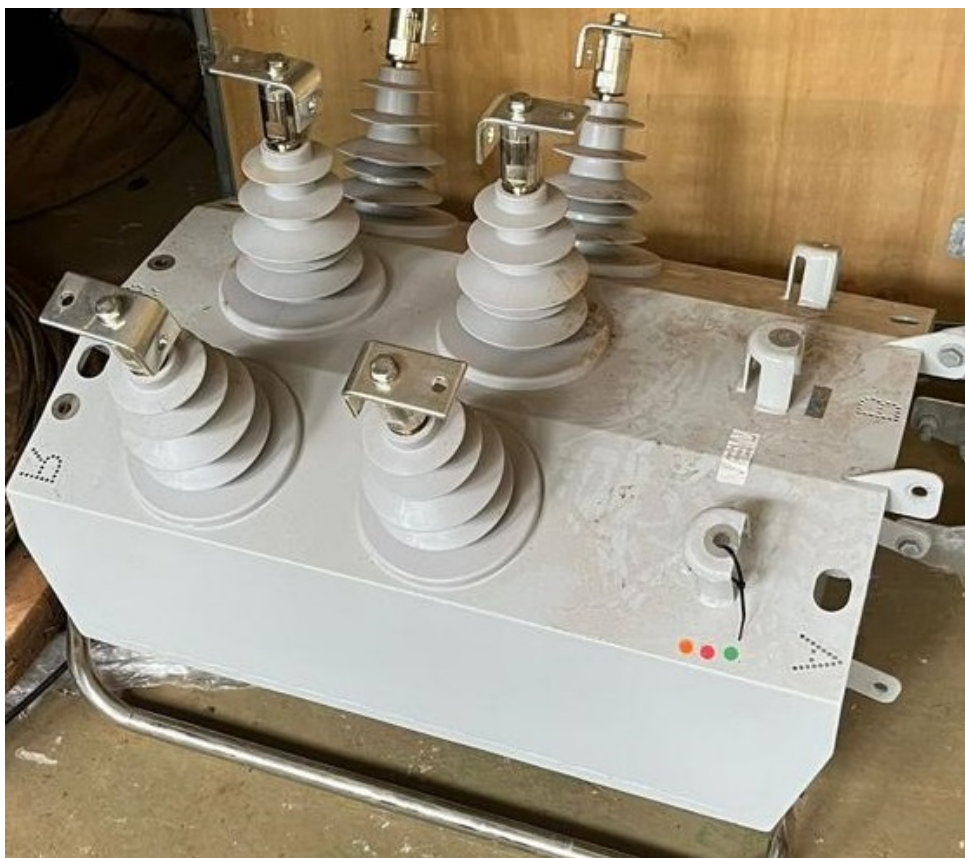
Figura 13 – Religador de energia elétrica (Autoria própria).
