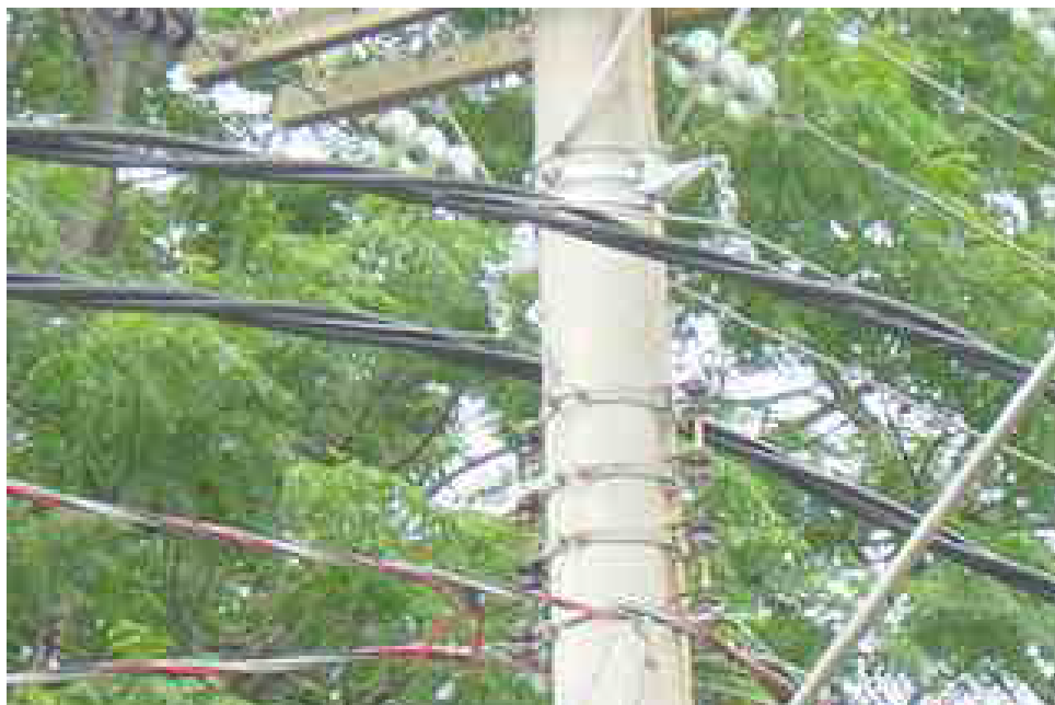
Figura 6 – Rede de distribuição aérea isolada (CELESC, 2020).
