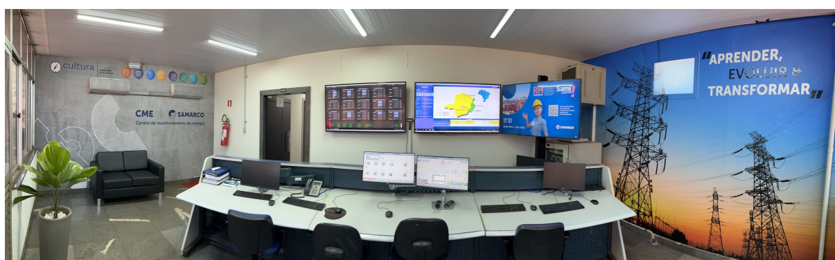
Figura 18 – Centro de Monitoramento de Energia (Autoria própria).
