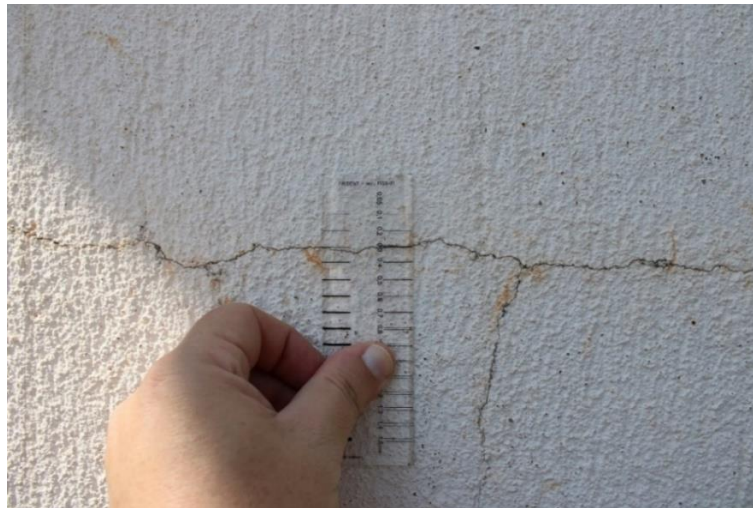
Figura 12 - Fissura próxima da janela da lavanderia
