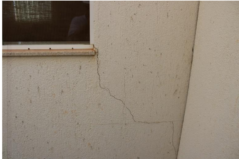
Figura 20 - Trinca diagonal saindo da janela da sala
