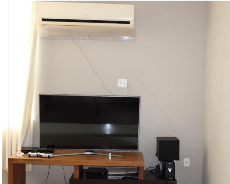
Figura 31 - Trincas diagonais no escritório
