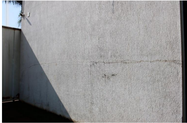
Figura 14 - Trinca horizontal em alvenaria da área externa
