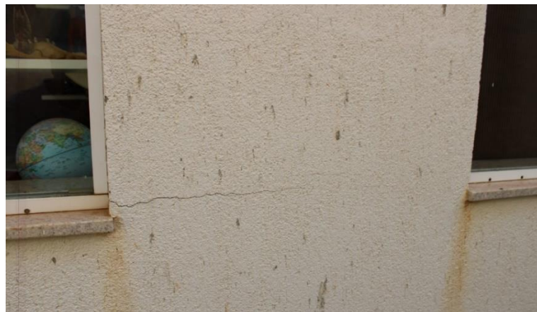
Figura 19 – Abertura gradual horizontal saindo da parte inferior da janela do quarto da frente
