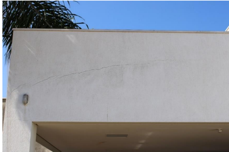
Figura 25 - Trinca na cobertura da garagem
