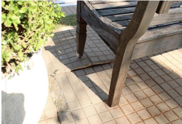
Figura 21 - Deslocamento na calçada da residência
