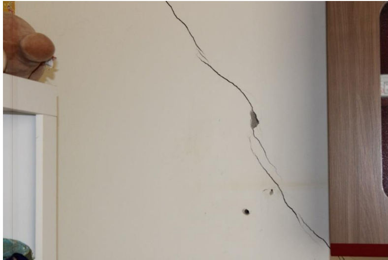
Figura 36 - Trinca diagonal no quarto da frente
