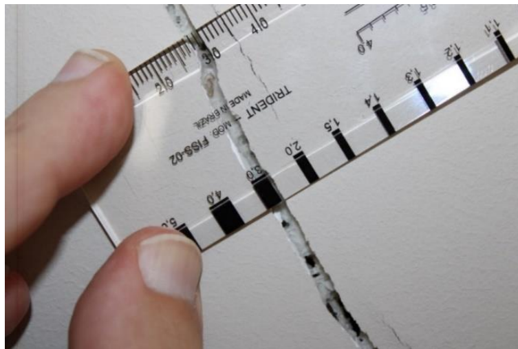
Figura 29 - Medição de trinca na parte lateral do escritório
