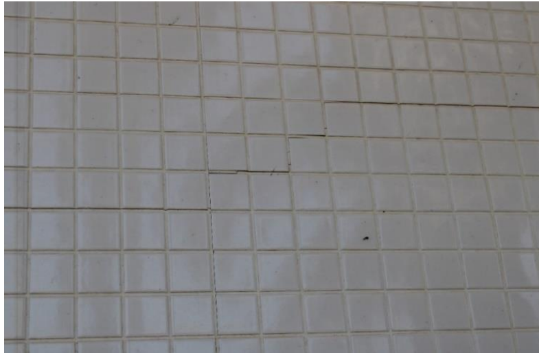
Figura 16 – Fissuras com padrão geométrico no rejunte do revestimento da fachada
