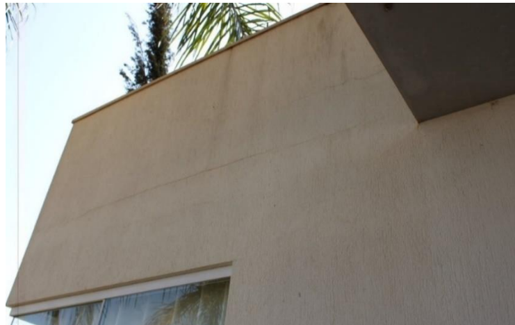
Figura 13 - Trinca localizada na interface entre a laje e a alvenaria de vedação
