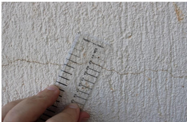
Figura 11 – Medição de fissuras constatando 0,2 mm
