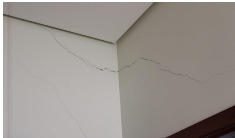
Figura 28 - Vista interna da trinca diagonal no canto de parede
