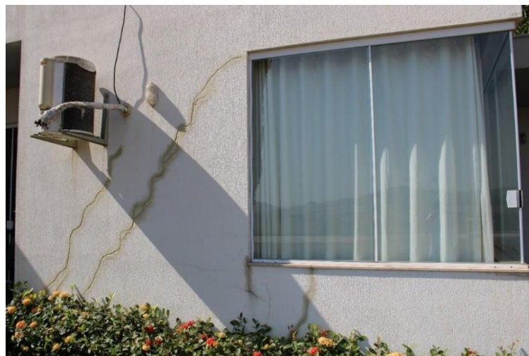
Figura 23 - Trincas na fachada externa da sala com vestígios de reparo superficial
