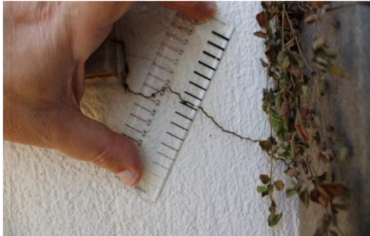
Figura 15 - Trinca de 0,8 mm saindo da janela da cozinha
