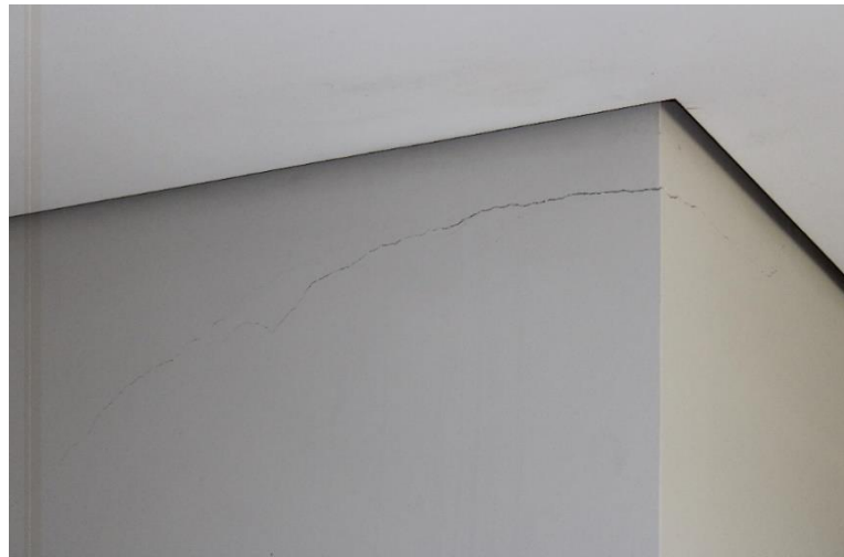
Figura 27 - Trinca em quina de parede entre a sala e o dormitório da frente
