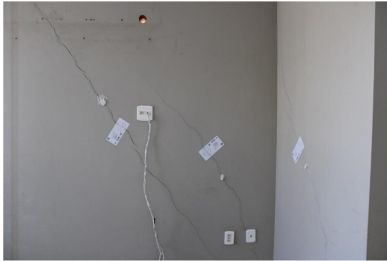
Figura 24 - Registro do monitoramento das trincas na alvenaria interna da sala
