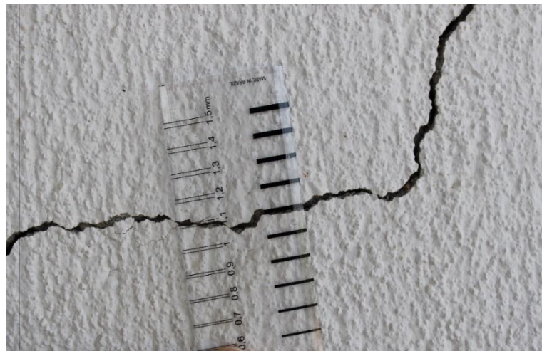
Figura 9 - Medição da trinca na alvenaria da entrada
