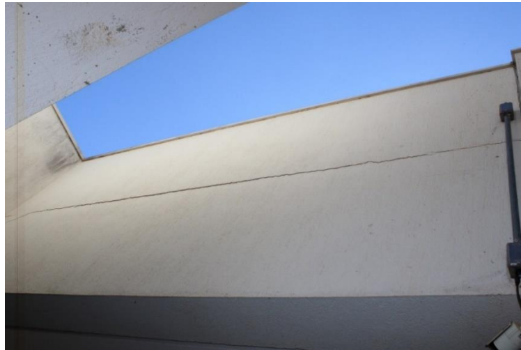
Figura 26 - Trinca longitudinal na viga lateral da garagem por excesso de flecha por flexão
