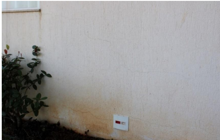
Figura 10 – Fissuras mapeadas na parte inferior da fachada da residência
