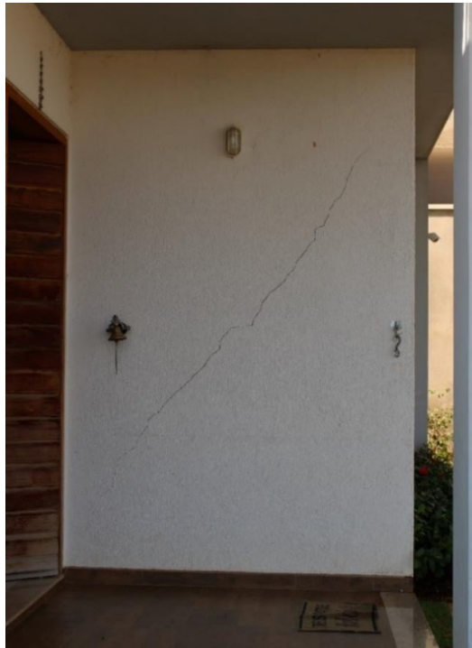
Figura 8 - Trinca em alvenaria da entrada
