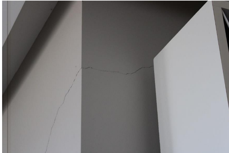
Figura 35 - Trinca em quina de parede entre a sala e o escritório
