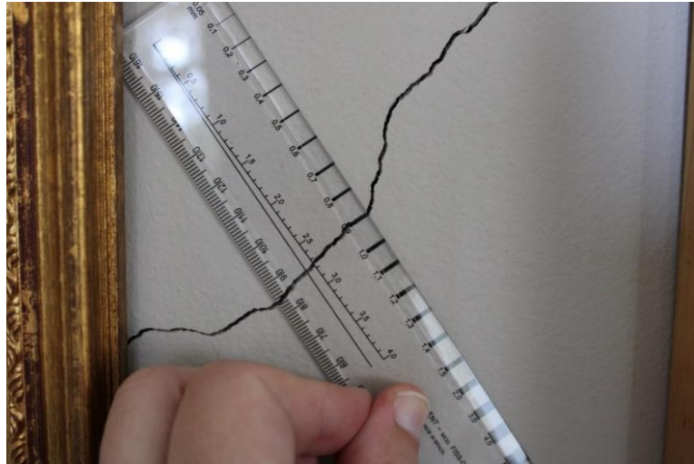
Figura 32 - Medição da trinca na parede de divisória entre o escritório e a sala
