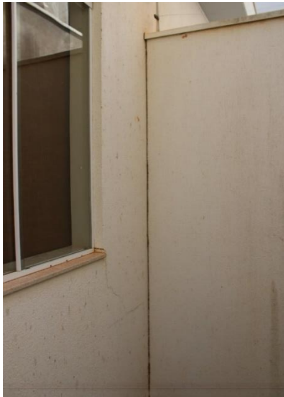
Figura 17 – Fenda entre a ligação de alvenarias na parte lateral direita externa
