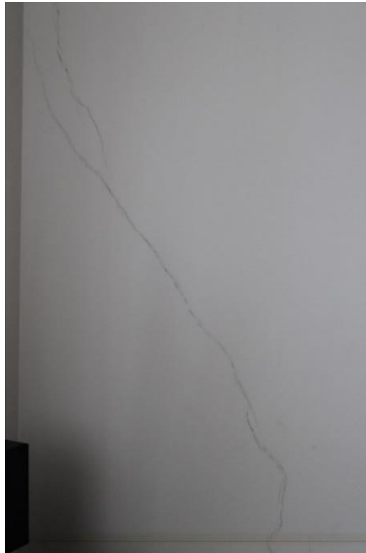
Figura 30 - Trinca em parede lateral do escritório
