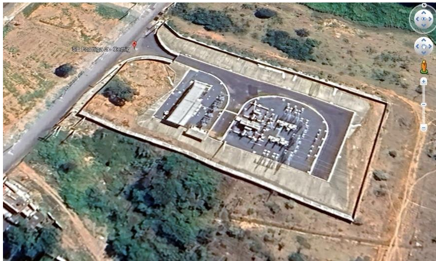
Figura 8- Subestação número 2 de Formiga-MG.
