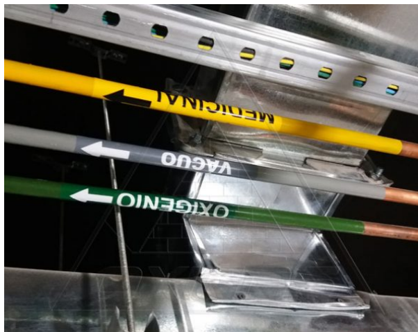
Figura 1 – Tubulação de gases medicinais
