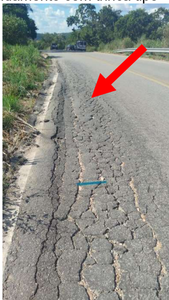
Figura 32 – Afundamento com trinca tipo “couro de jacaré”
