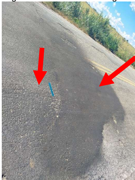
Figura 40 – Remendo e desgaste
