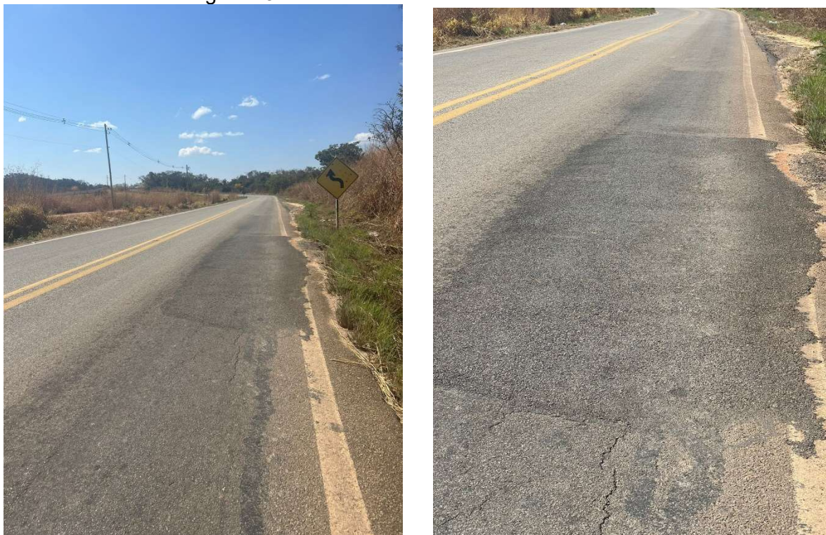
Figura 25 – Remendo com desnível e seu detalhe
