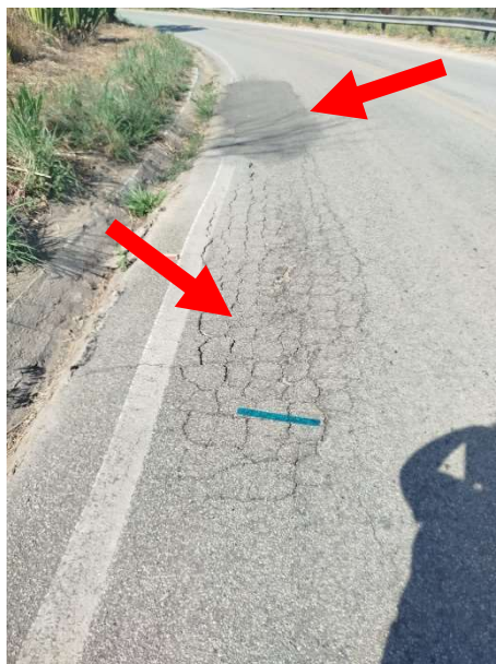
Figura 35 – Remendo e trincas
