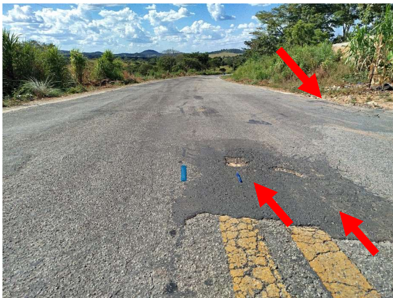
Figura 59 – Panelas, afundamentos e remendos
