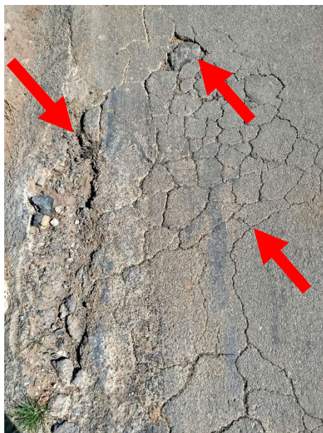
Figura 57 – Painéis e trincas
