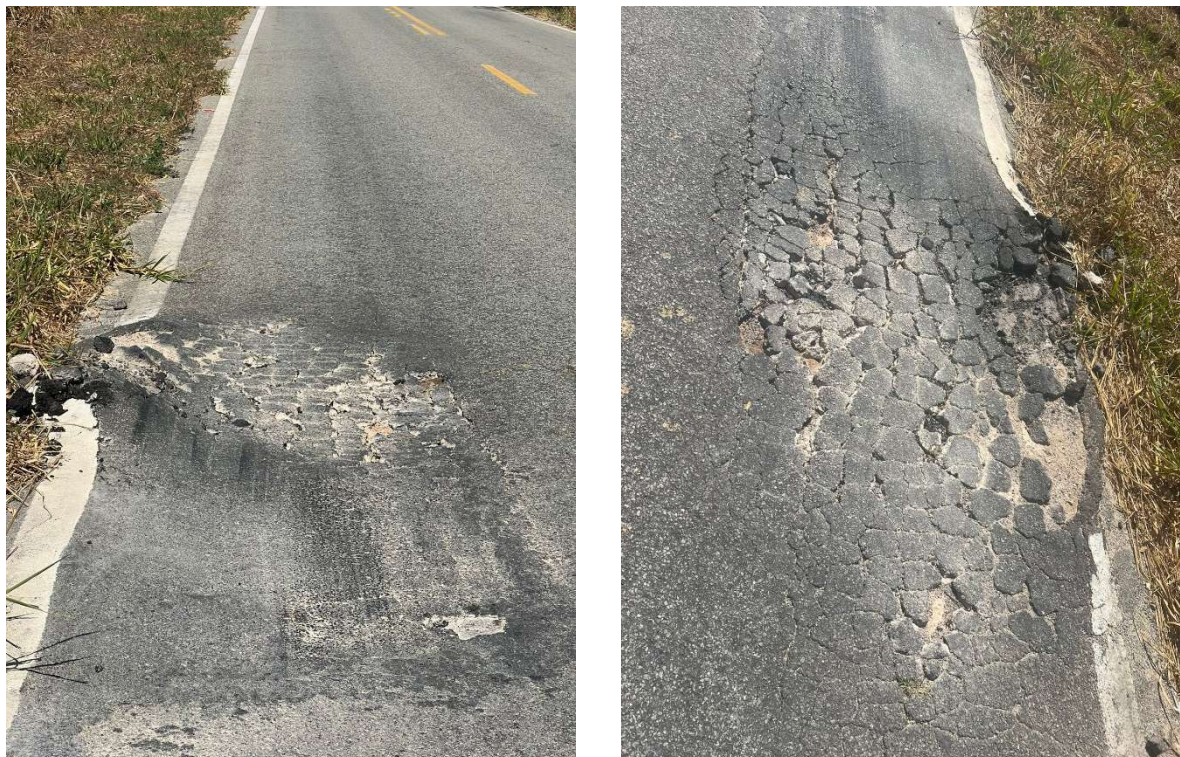
Figura 24 – Afundamento com "couro de jacaré"
