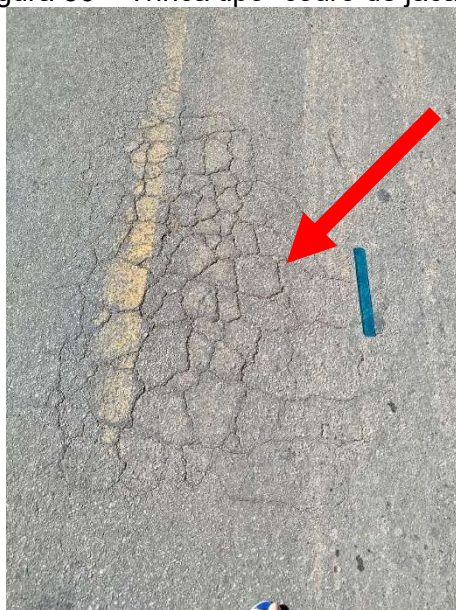
Figura 56 – Trinca tipo “couro de jacaré”
