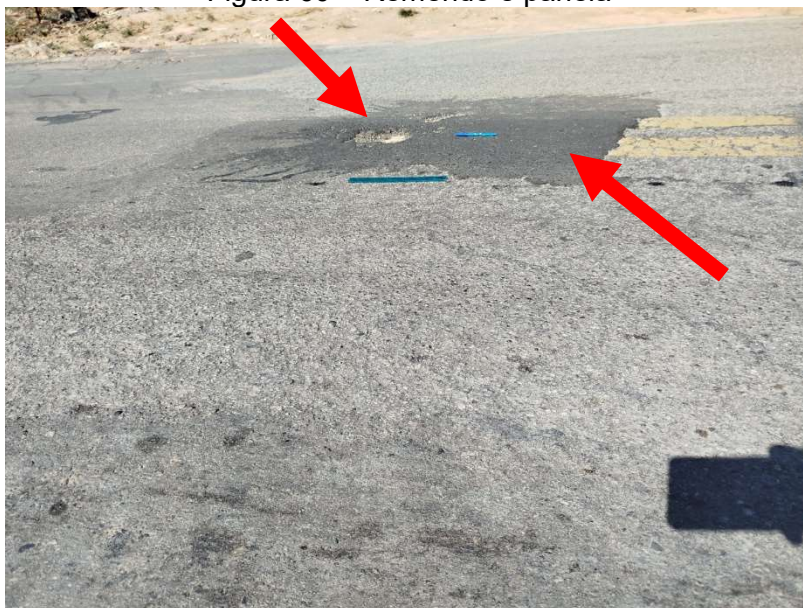
Figura 60 – Remendo e panela
