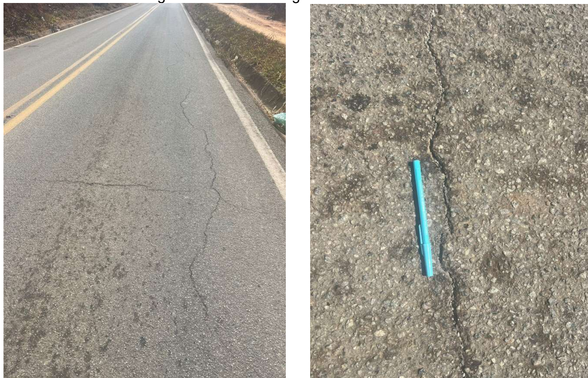
Figura 22 – Trinca Longitudinal e seu detalhe
