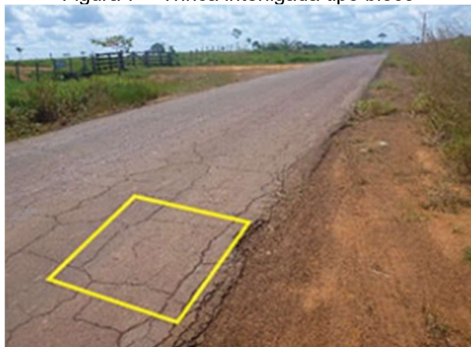
Figura 7 – Trinca interligada tipo bloco
