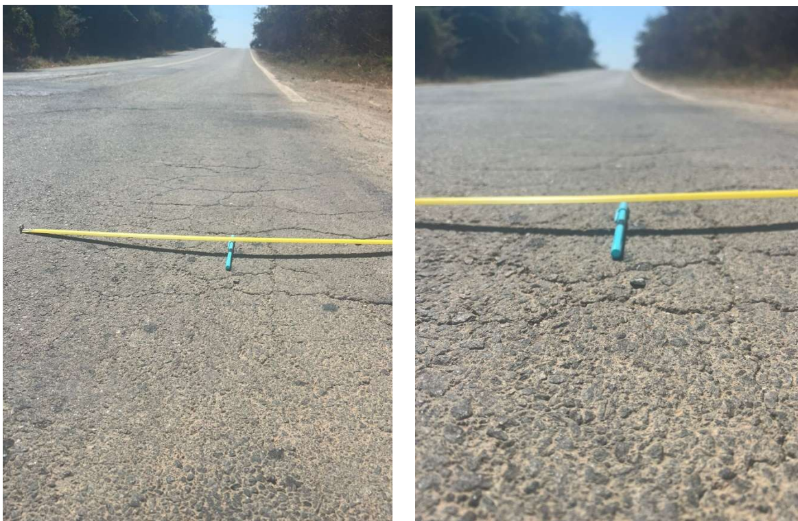
Figura 23 – Afundamento do asfalto e seu detalhe
