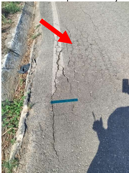
Figura 34 – Trincas tipo “couro de jacaré”
