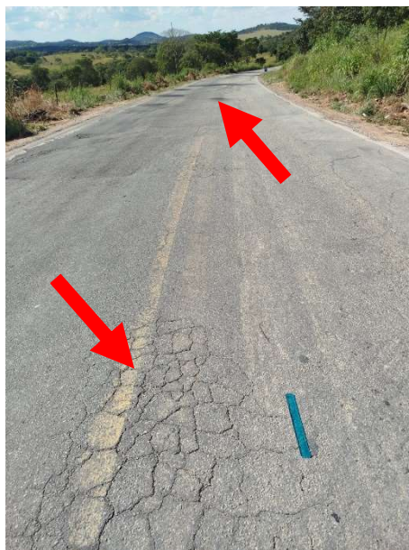
Figura 55 – Remendos e trincas
