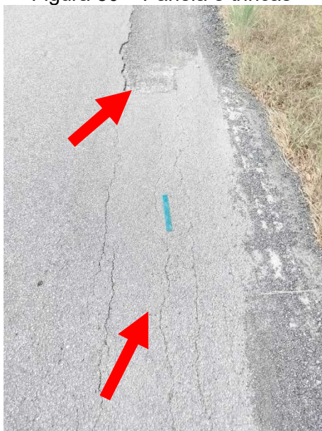
Figura 50 – Panela e trincas
