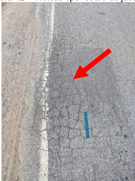
Figura 42 – Trincas tipo “couro de jacaré”
