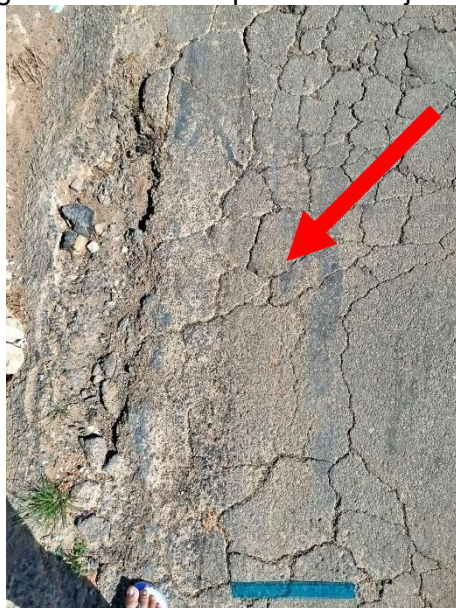
Figura 58 – Trinca tipo “couro de jacaré”
