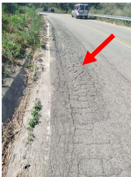
Figura 33 – Afundamento com trinca tipo “couro de jacaré”
