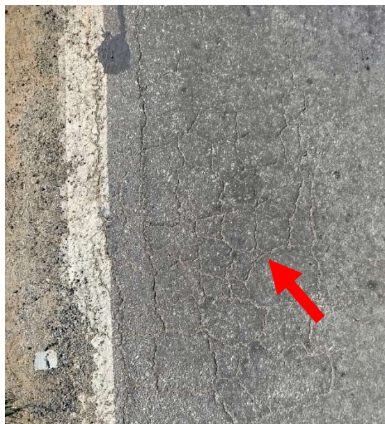
Figura 61 – Trincas tipo “couro de jacaré”
