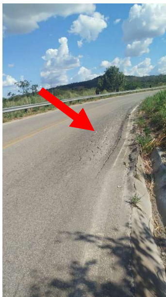
Figura 31 – Afundamento com trinca tipo “couro de jacaré”
