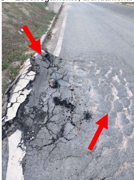
Figura 48 – Escorregamento, afundamento e trincas
