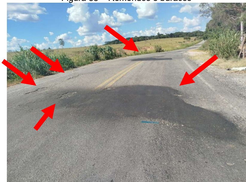
Figura 38 – Remendos e buracos
