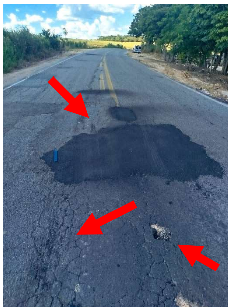
Figura 41 – Remendos, trincas e panelas
