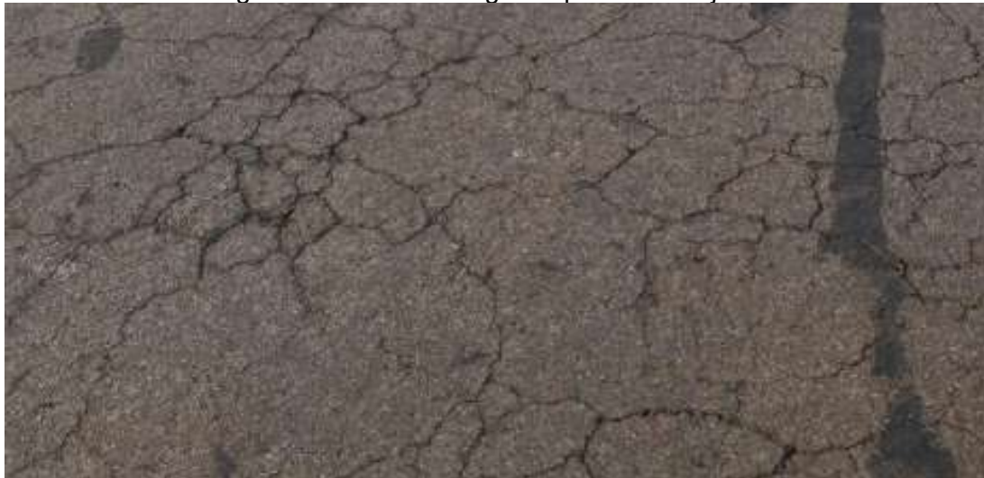
Figura 6 – Trinca interligada tipo couro de jacaré
