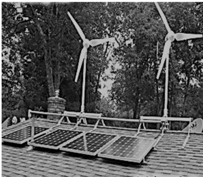
Figura 7 - Sistema híbrido com aerogeradores e células fotovoltaicas.
