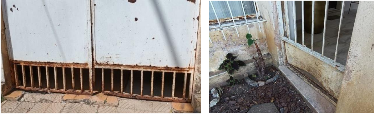
Figura 15 e 16: Danos em elementos metálicos. Fonte: Autoras (2023)
