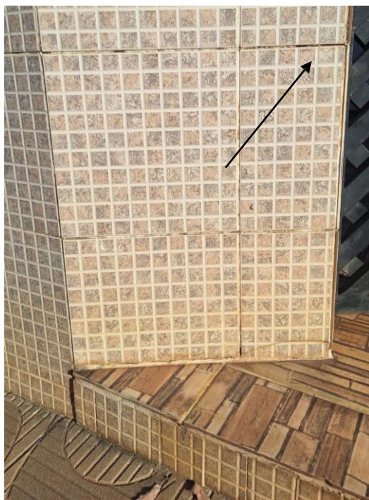
Figuras 12: Ausência de rejunte devido a penetração da água. Fonte: Autoras (2023)
