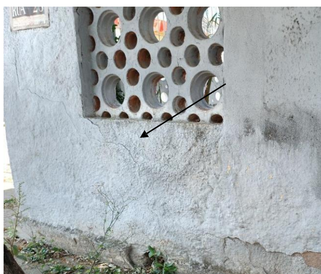
Figura 05: Trinca por recalque Fonte: Autoras (2023)
