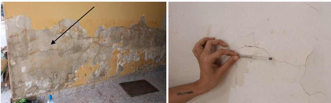
Figuras 03 e 04: Trincas e fissuras Fonte: Autoras (2023)
