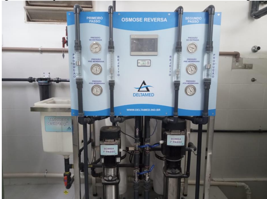
Figura 3 – Máquina de Osmose Reversa do Nefrocentro de Formiga/MG.
