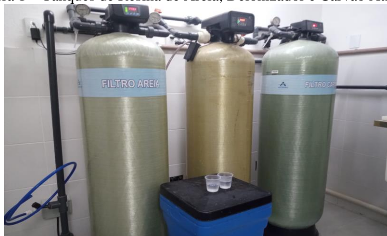
Figura 1 – Tanques de Resina de Areia, Deionizador e Carvão Ativado.
