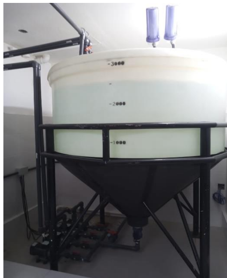
Figura 4 – Tanque de água ultrapura.
