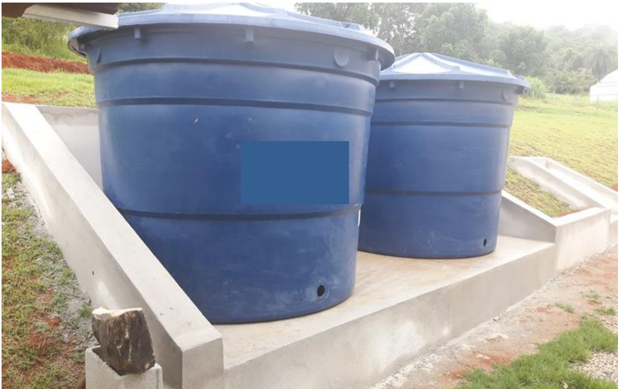
Figura 22 - Reservatório de água com capacidade para 10.000 litros
