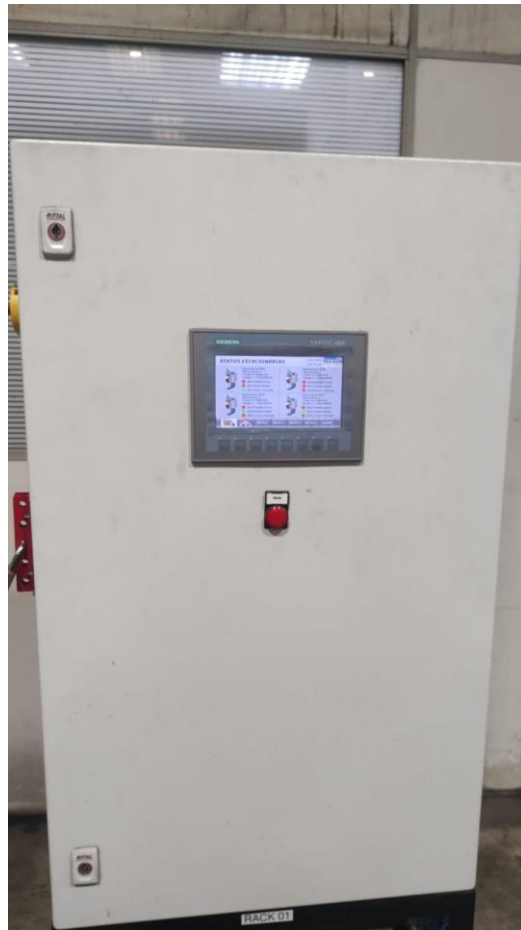
Figura 26 – Vista externa do painel de interlock.
