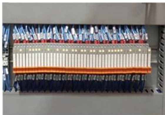
Figura 15 – Relés de acionamento.
