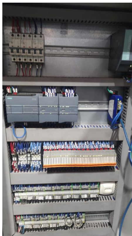
Figura 25 – Vista interna do painel de interlock.
