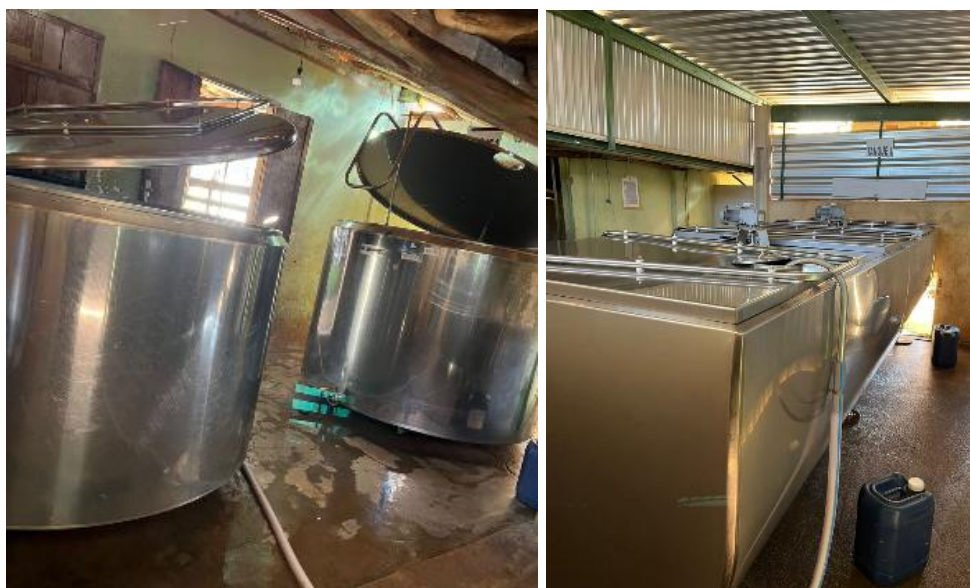
Figura 3: Tanques resfriadores do leite
