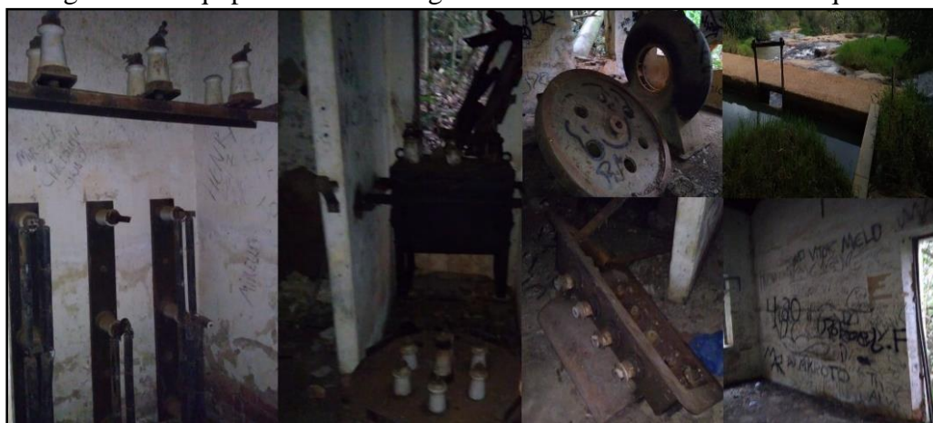
Figura 26 - Equipamentos da antiga usina hidrelétrica e Casa de máquinas
