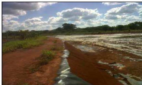
Manta danificada – Lagoa de Polimento
