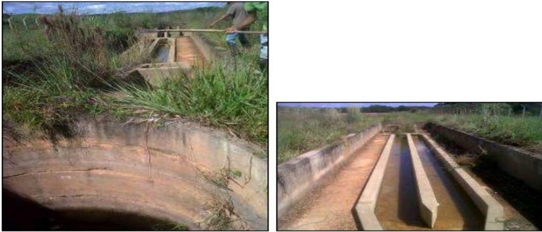
Poço sucção EEF e Tratamento Preliminar
