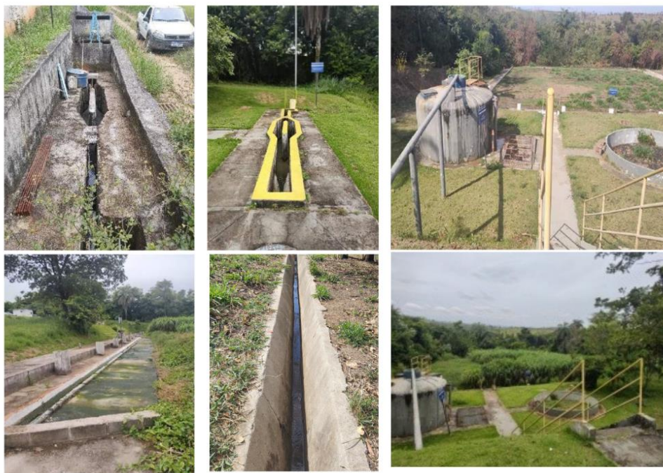
Figura 32 - Estação de Tratamento de Esgoto APAC em Santa Luzia
