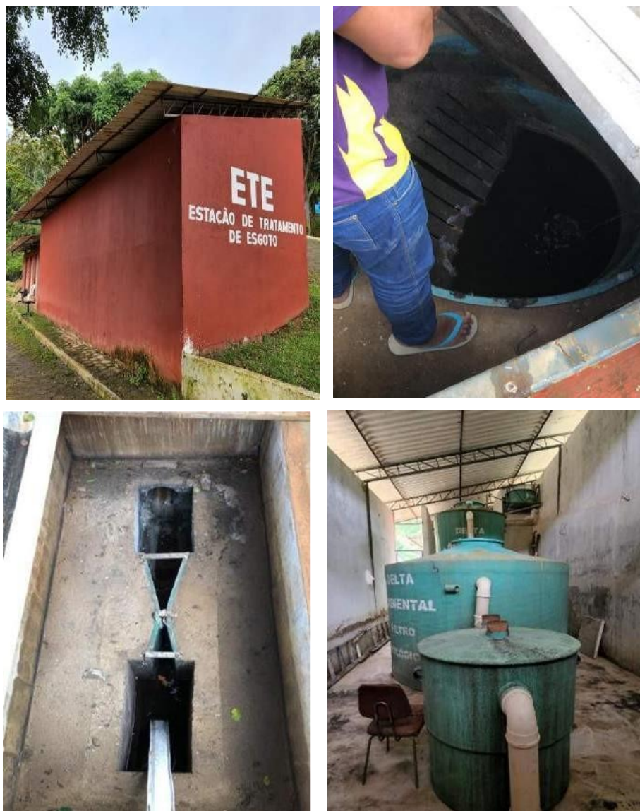
Figura 24 - Estação de Tratamento de Esgoto APAC Caratinga, 2023
