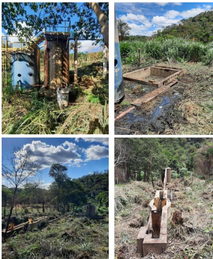
Figura 30 - Estação de Tratamento de Esgoto do Presídio Caratinga
