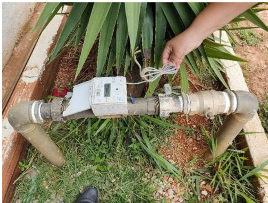
Figura 9 - Hidrômetro instalado na entrada do presídio “Promotor José Costa”
