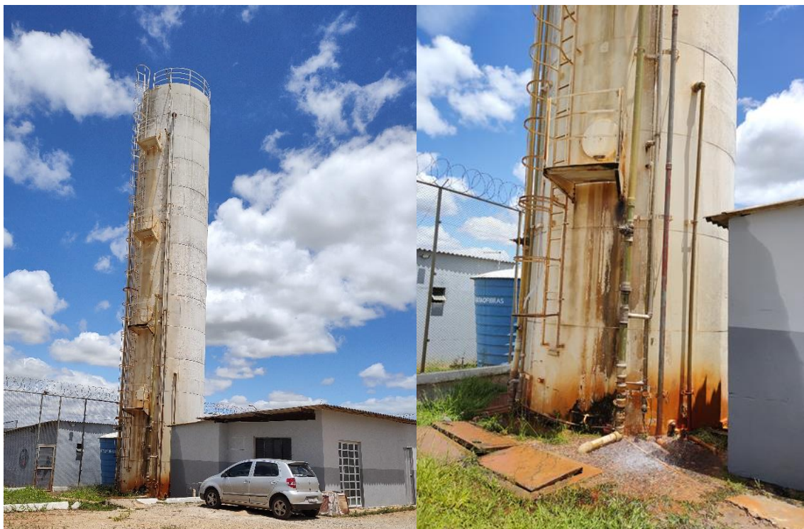
Figura 8: Taça d'água de entrada da unidade abastecida pelo poço artesiano
