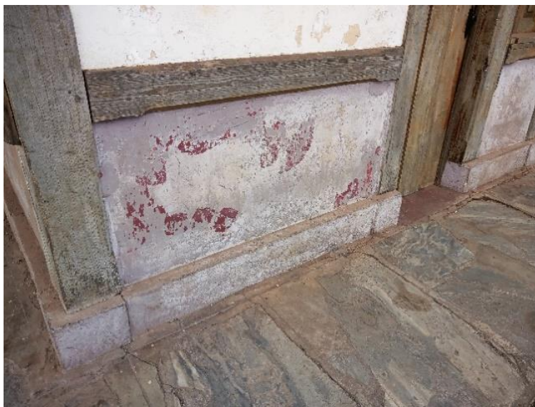
Figure 31 - Desgaste da pintura e fresta das portas de trilhos da Estação Ferroviária de Rodrigo Silva
