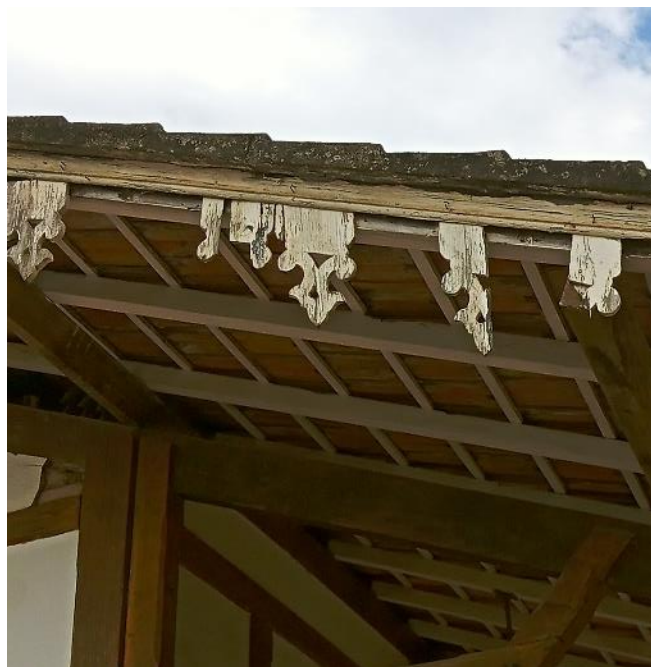
Figure 32 - Partes do lambrequim faltantes da Estação Ferroviária de Rodrigo Silva
