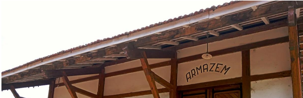
Figure 33 - Ausência dos lambrequins do lado do armazém da Estação Ferroviária de Rodrigo Silva
