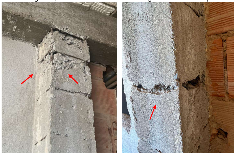
Figura 23: Pilar com ninhos de concretagem e armadura exposta
