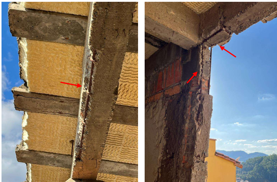
Figura 25: Armadura exposta e segregação
