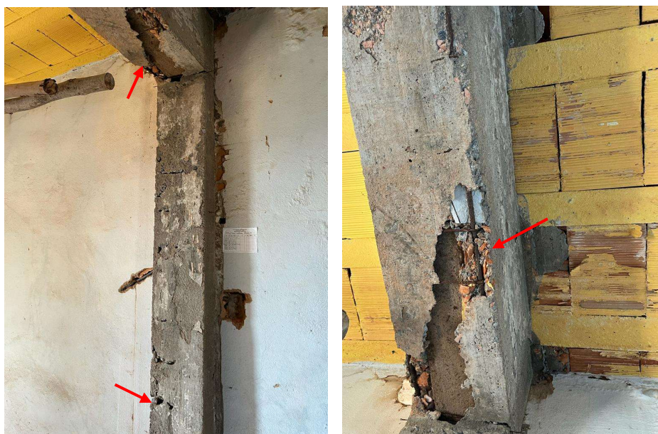
Figura 24: Segregação profunda na viga e pilar.
