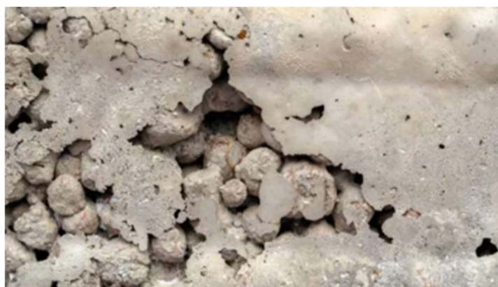
Figura 15: Bicheiras na concretagem
