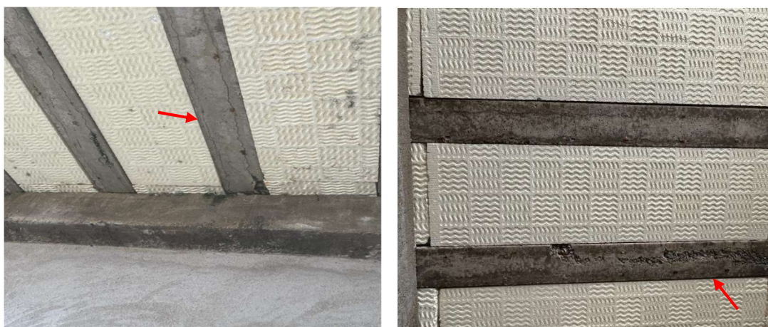
Figura 28: Fissuras Horizontais e segregação
