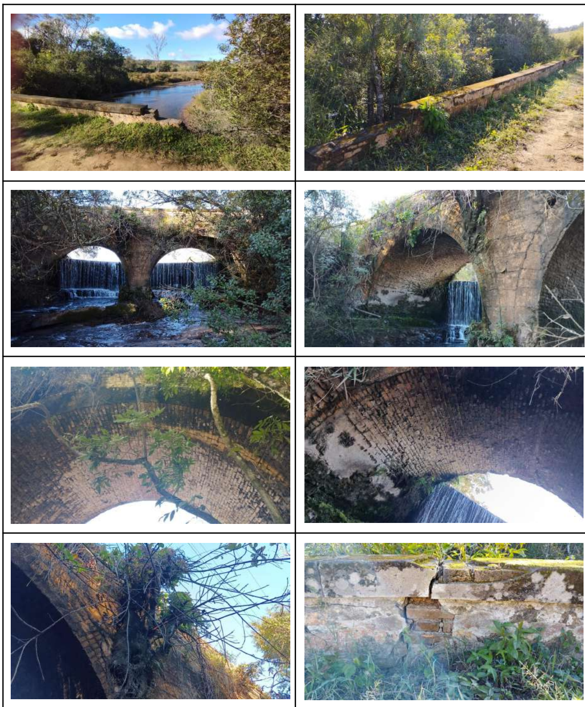
Figura 16: Principais danos observados em julho de 2023.
