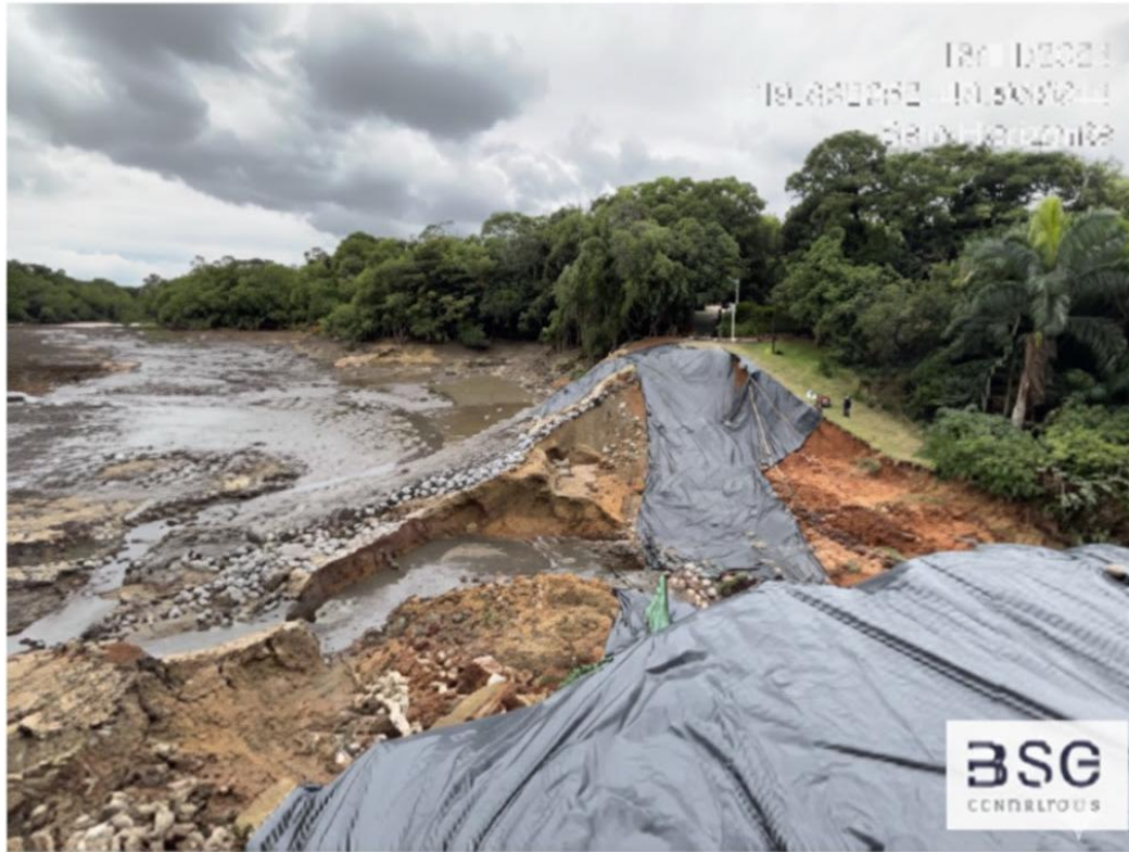
Figura 15 – Situação do barramento após a ruptura
