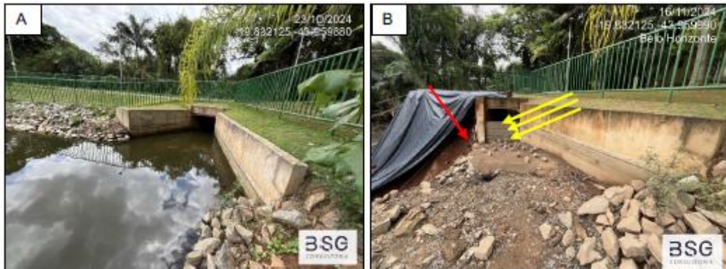
Figura 16 – Emboque do vertedouro: (A) antes do rompimento; (B) após o rompimento
