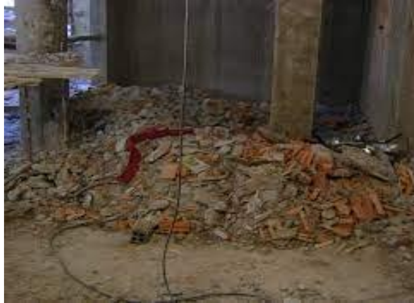
Figura 4 - Desperdícios na execução de alvenaria de vedação.
