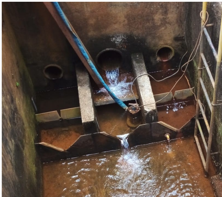
Figura 7 – Exemplo de três medidores de vazão triangulares com destaque para o medidor central atualmente em operação.
