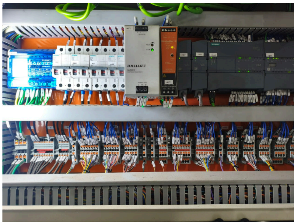
FIGURA 49 - Painel elétrico da última linha aplicada a padronização
