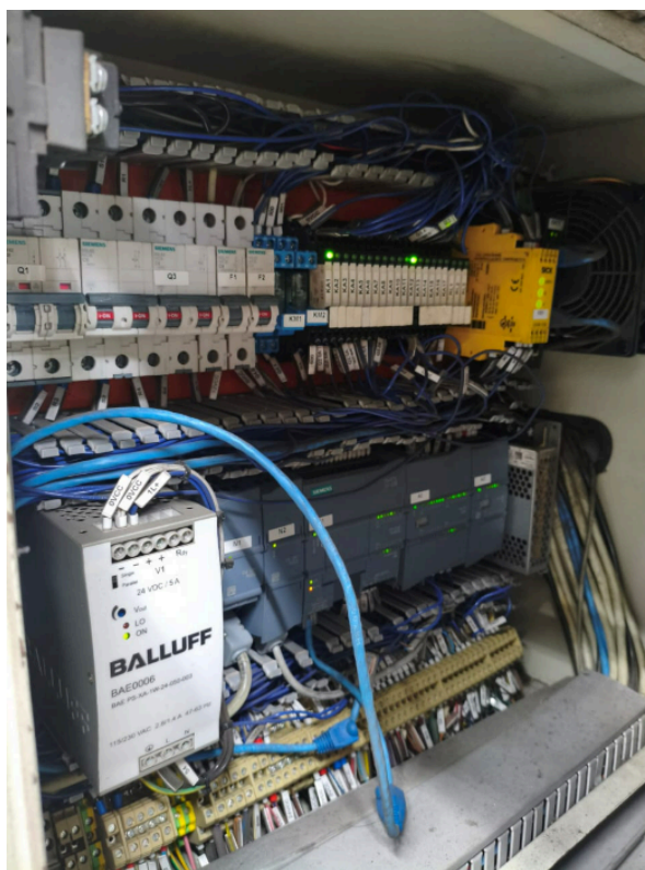
FIGURA 3 - Painel Elétrico antes da aplicação do padrão
