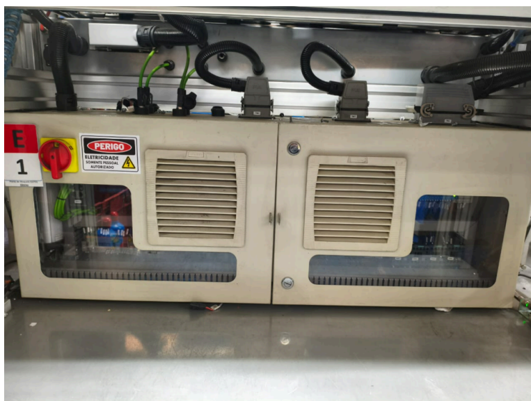
FIGURA 22 - Painel elétrico da segunda linha aplicada a padronização
