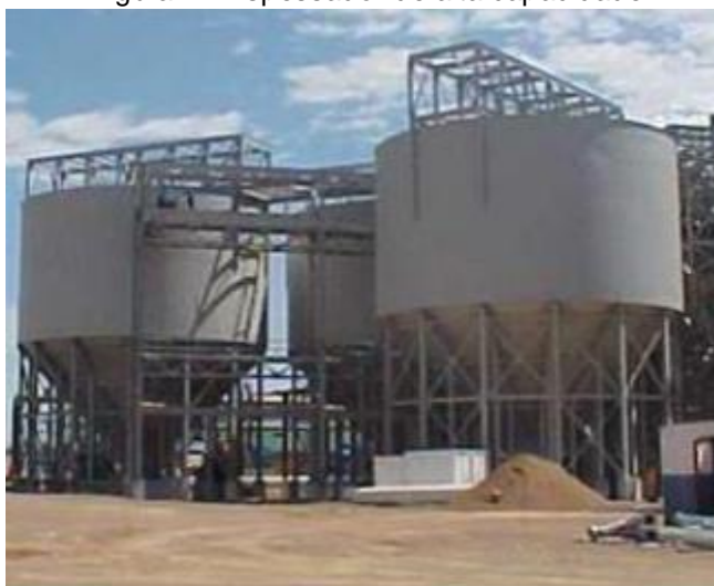
Figura 7 - Espessador de alta capacidade
